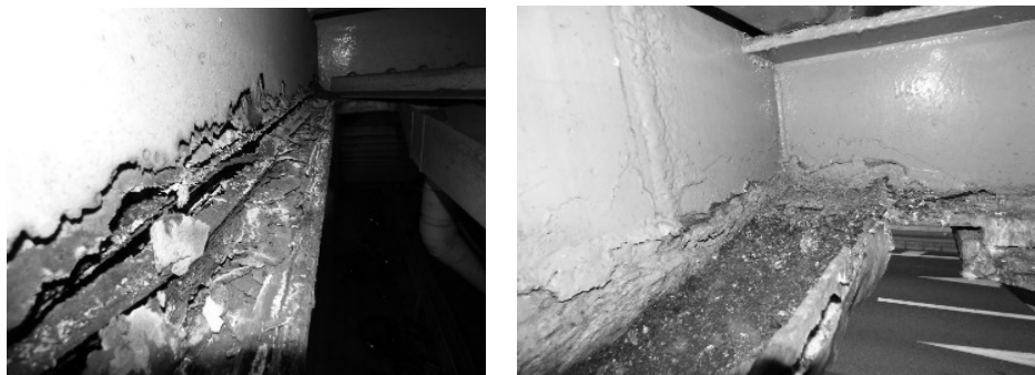
図－8 横断歩道橋の主桁の腐食事例
