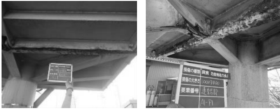
図－１０ 横断歩道橋の階段部の腐食事例
