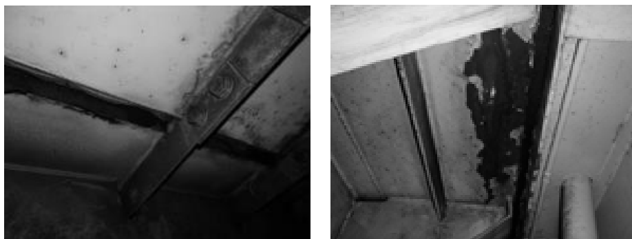
図－9 横断歩道橋の床版の腐食事例
