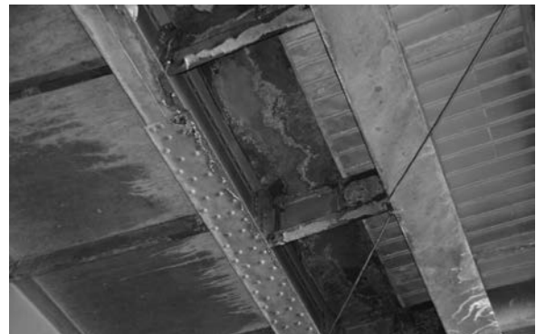
写真-3.3.2 床版の漏水跡と錆汁
