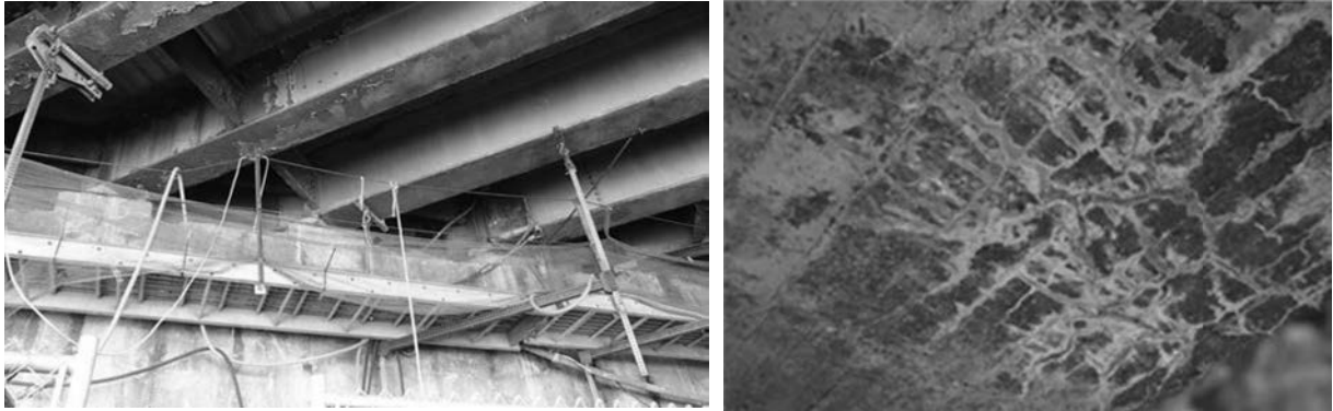
写真-3.3.1 ブルックリン橋アプローチの塩害損傷
