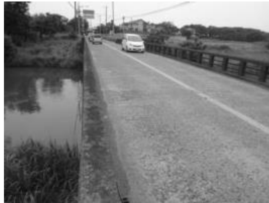
写真-2.1.11 上船渡橋の路面の状況 (2013.6)
