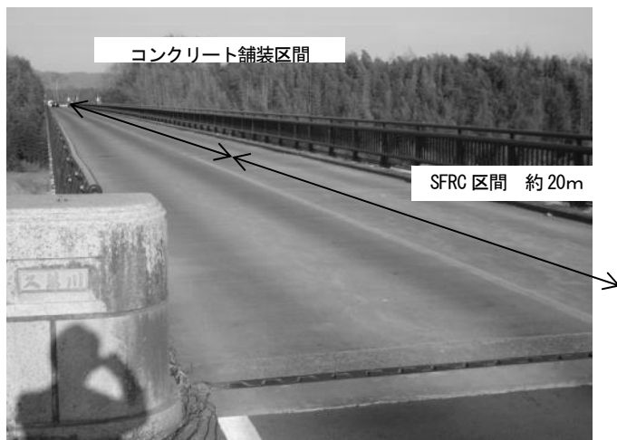
写真-2.1.7 栄橋の路面の状況 (2014.1)
