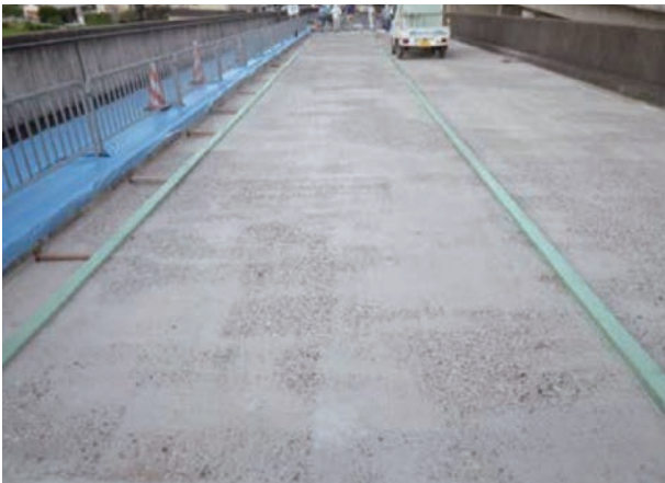
ショットブラスト処理後の橋梁床版
