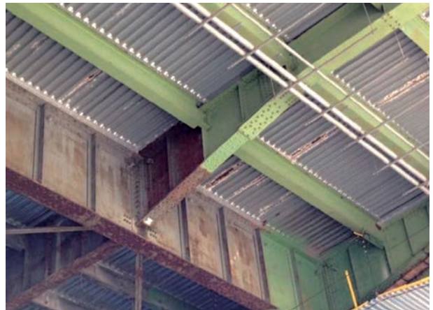
床版下面の残存型枠
