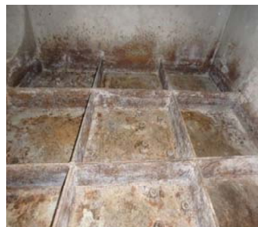
〔錆の状況(下面)〕
