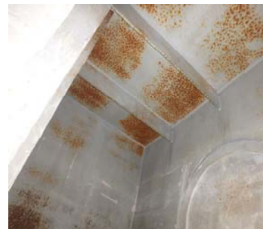
〔錆の状況(上面)〕
