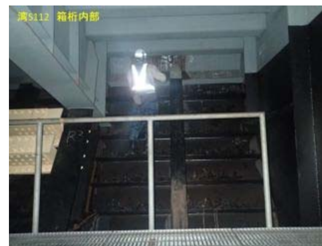
〔損傷発生箇所〕
