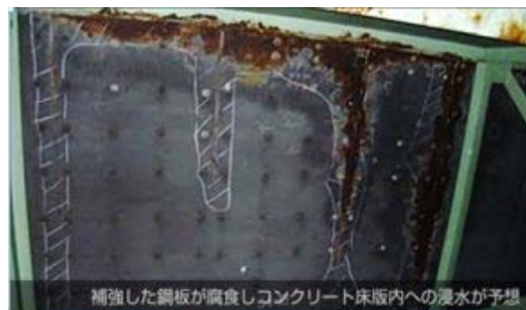
〔補強鋼板の腐食〕
