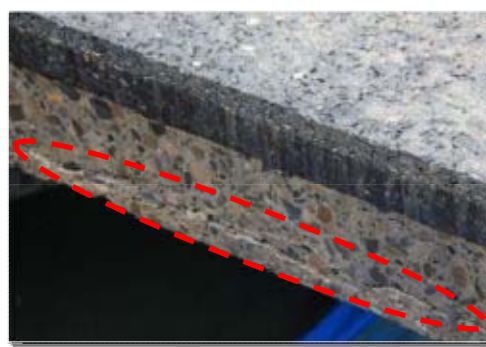
〔床版内部ひび割れの状況〕
