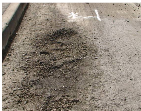
図-付 4.10.5 床版コンクリートの砂利化
