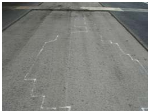
図-付 2.3.13 損傷箇所のマーキング
