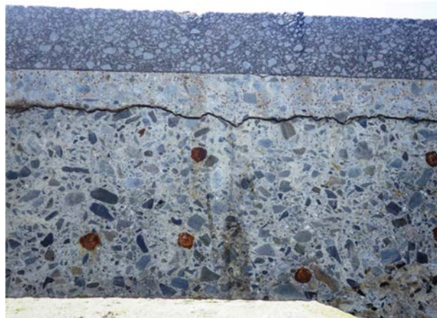
図-付 1.26 事例 5, 床版切断面, 増厚コンクリートのはく離
