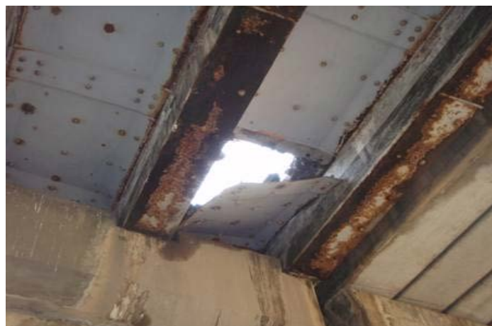
図-付 1.60 事例 11, 抜け落ち状況 (上：路面, 下：下面の補強鋼板の剥がれ)
