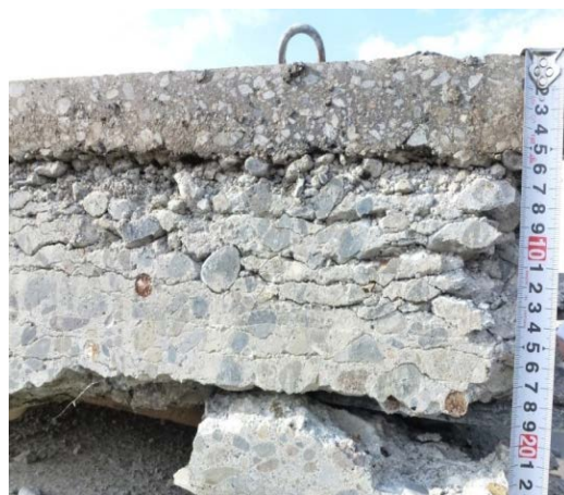
図-付 1.7 事例 1, 床版切断面の砂利化
