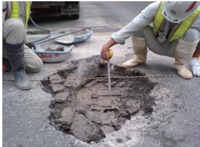
図-付 1.32 事例 6, RC 床版上面の土砂化
