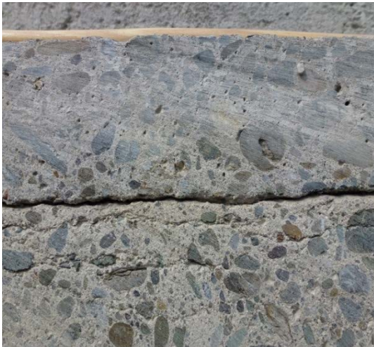
図-付 1.12 事例 2, 床版切断面, 第 2 径間主桁上
