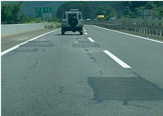
図-付 1.40 事例 7, 8 共通, 路面の状況
