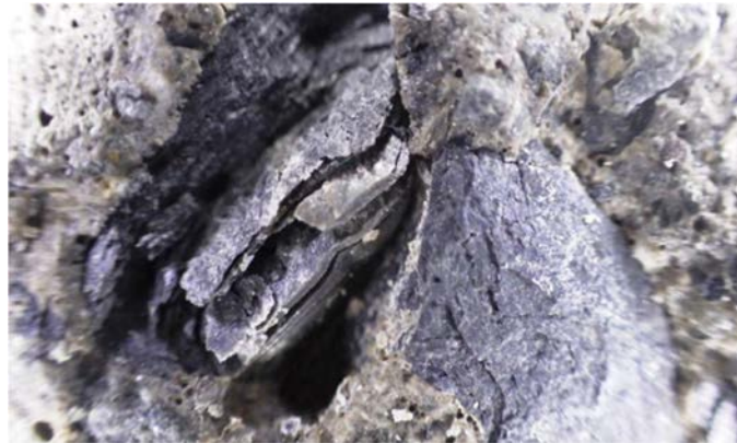
図-付 1.29 事例 5, 骨材の劣化 (凍害)
