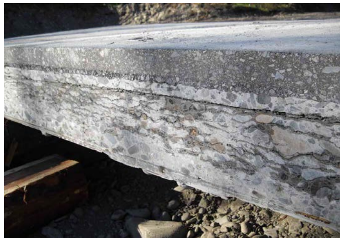
図-付 1.63 事例 11, 床版からの漏水状況 (図-付 1.60 とは別の径間)
