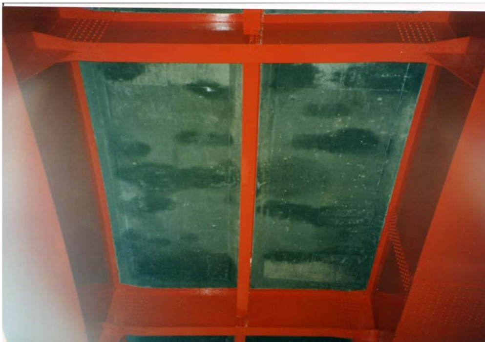
図-付 1.52 事例 10, 床版下面の状況 (図-付 1.55 の 8.5 年前)
