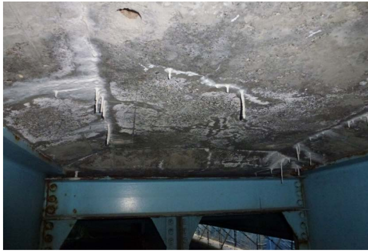
図-付 1.11 事例 2, 床版下面, 第 2 径間 P1 側
