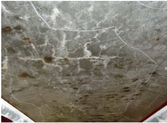
図-付 1.20 事例 4, P6-P7, G2-G3, ひび割れ・石灰分
