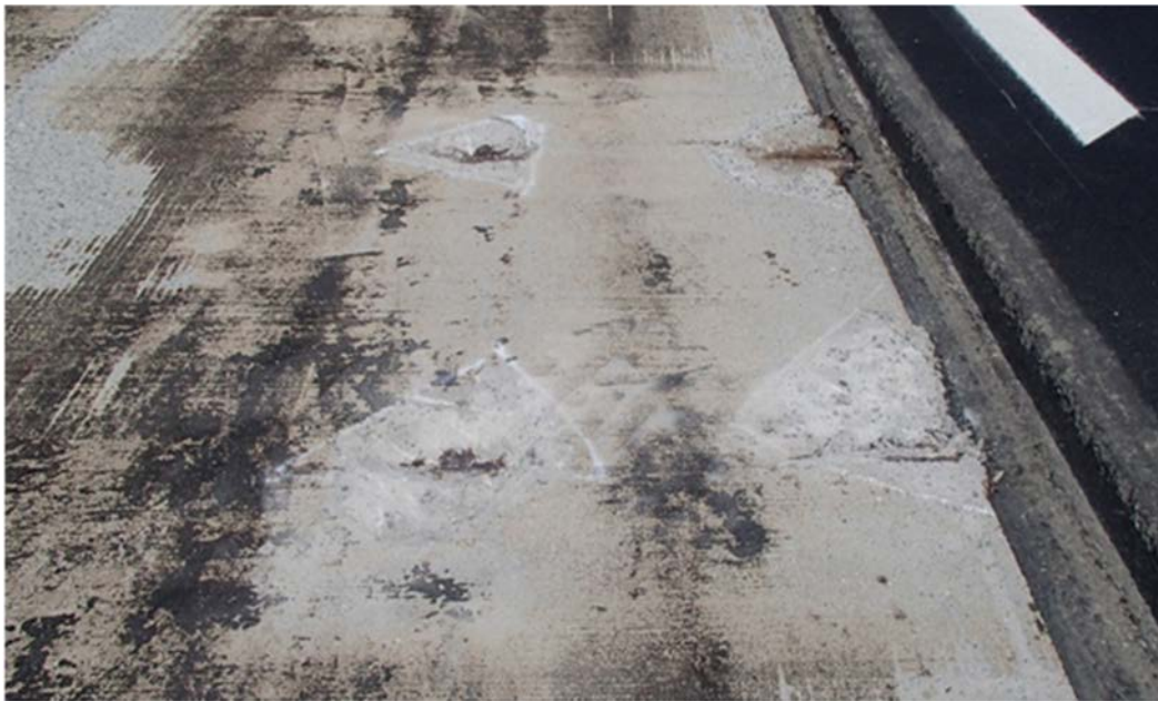
図-付 1.49 事例 9, 床版上面, 鉄筋腐食 (代表的な事例)
