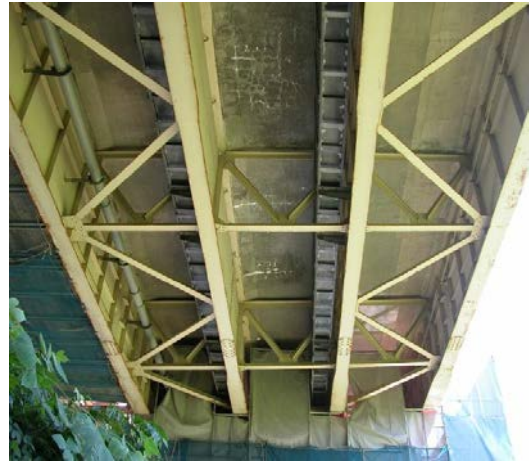
図-付 1.41 事例 7, 8 共通, 供用下の床版下面
