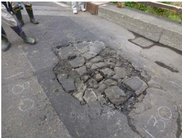
図-付 1.4 事例 1, 抜け落ち時の路面状況
