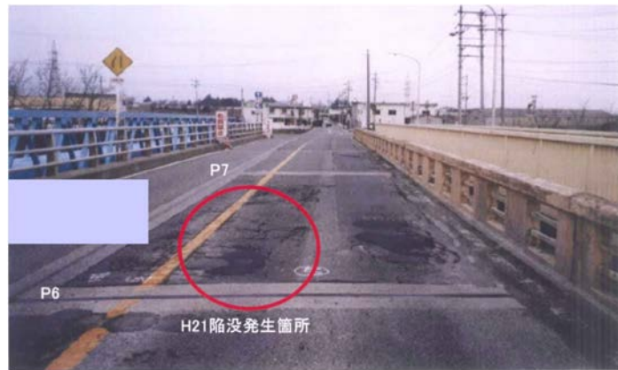
図-付 1.62 事例 11, 抜け落ち約 1 年前の舗装打換え前の路面劣化
