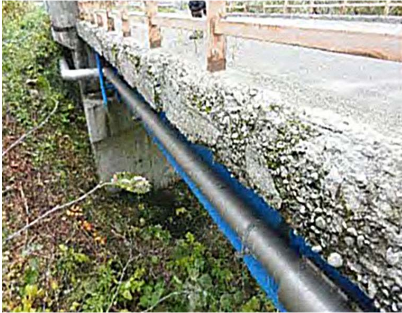
図-付 1.15 事例3, 床版端部のスケーリング
