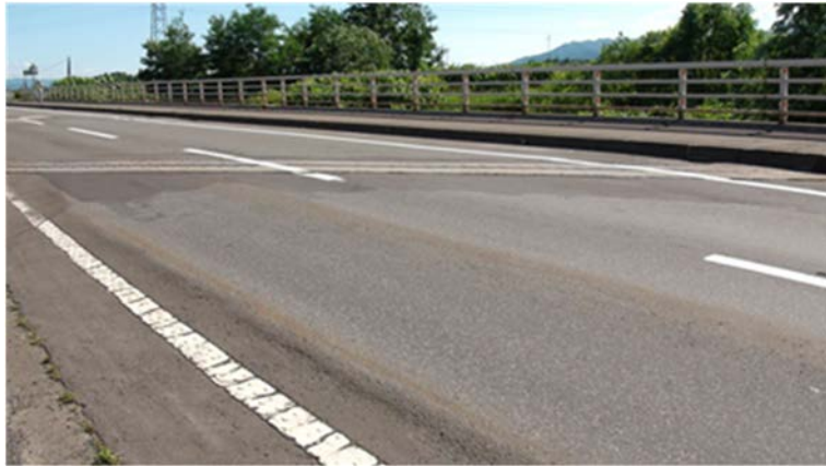
図-付 1.2 事例 1, 健全部の路面 (図-付 1.3~1.5 と同日に撮影)
