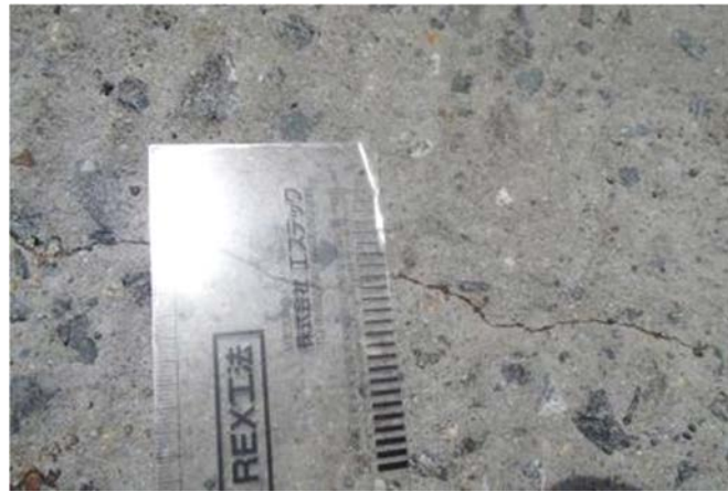
(c) ブラスト前, ひび割れ部の拡大 ((a)の赤点線内)
