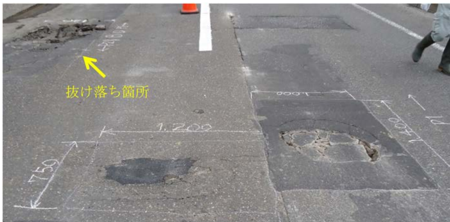
図-付 1.3 事例 1, 抜け落ち時の周囲の路面状況
