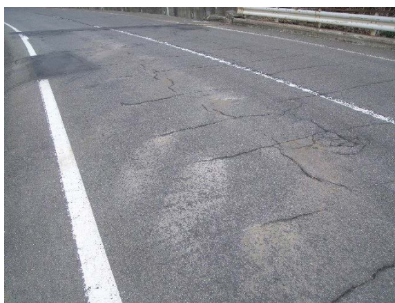
図-付 1.54 事例 10, 路面の状況
