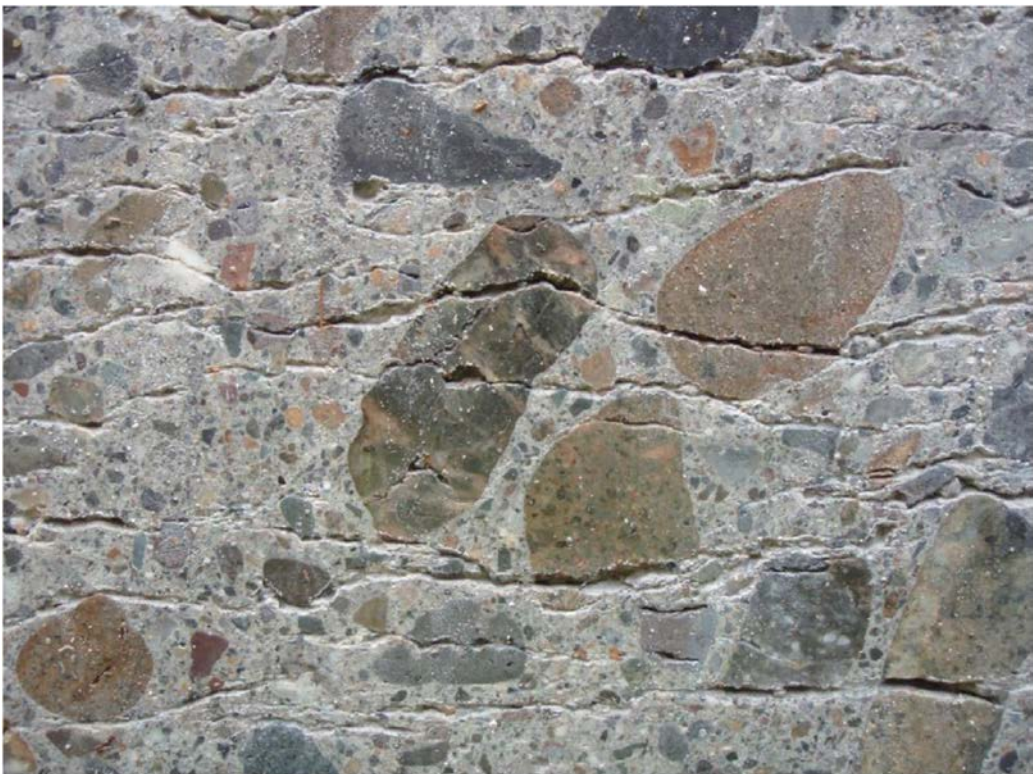
図-付 1.35 事例 6, RC 床版切断面の多数の水平ひび割れ (図-付 1.34 の拡大)
