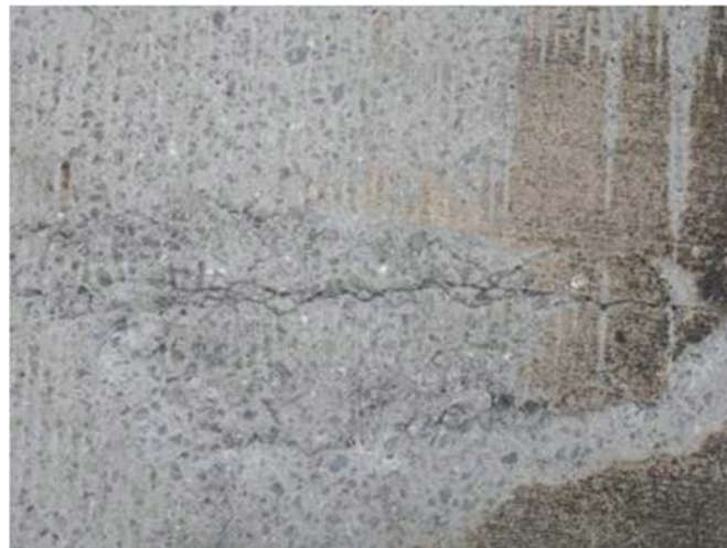
(d) ブラスト後, ひび割れ周辺の脆弱部が確認された箇所 ((b)の赤点線内)
