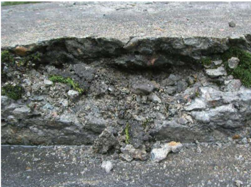
図-付 1.37 事例 6, スケーリングによる地覆コンクリートの崩壊
