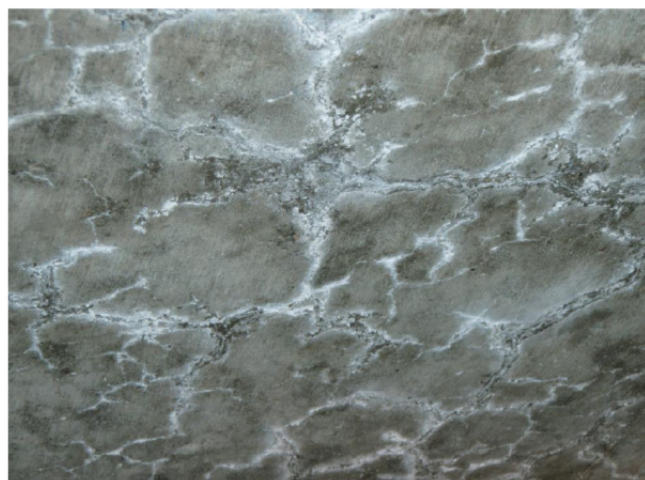
図-付 1.33 事例 6, RC 床版下面の網目状のひび割れと白色析出物
