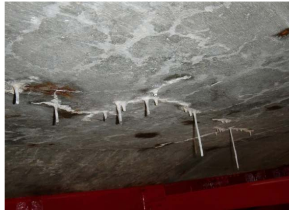
図-付 1.21 事例 4, P8-A2, G2-G3, 漏水を伴う石灰分
