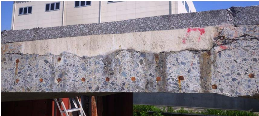
図-付 1.27 事例 5, 床版切断面, 部分補修部の再劣化 (はく離)
