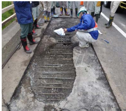
図-付 1.5 事例 1, 抜け落ち時の床版劣化状況
