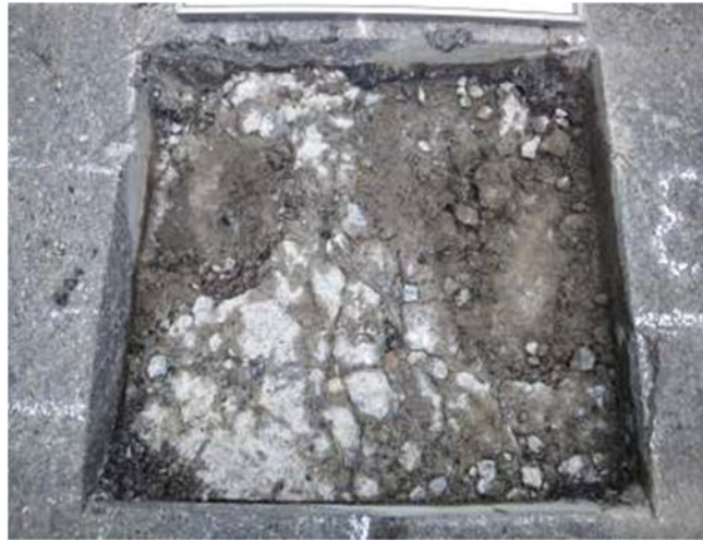
図-付 1.56 事例 10, No. 34, 舗装撤去後の床版上面 (たたくと脆い)
