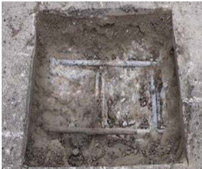
図-付 1.57 事例 10, No. 34, かぶりコンクリート撤去後
