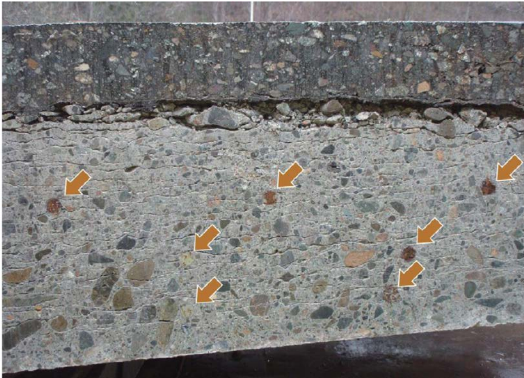
図-付 1.34 事例 6, RC 床版切断面の多数の水平ひび割れ (矢印の位置に鉄筋)
