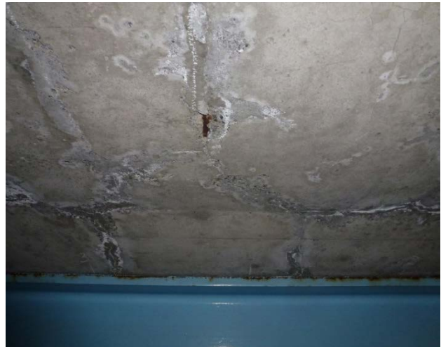
図-付 1.13 事例 2, かぶり不足による鉄筋腐食
