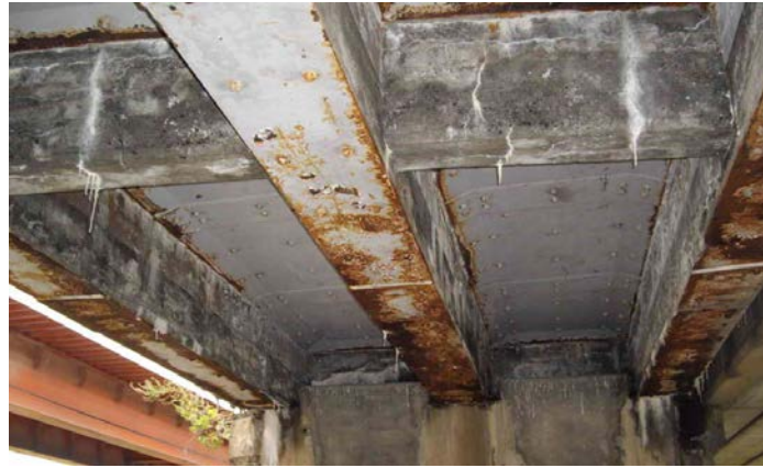
図-付 1.61 事例 11, 床版からの漏水状況 (図-付 1.60 とは別の径間)
