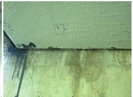
写真-3 塗装のはく離
