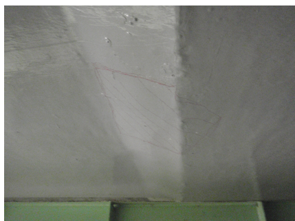
写真-7 ハンチ部の浮き
