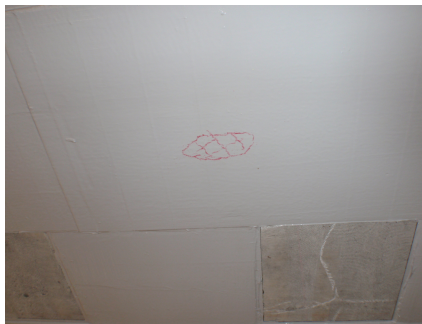
写真-5 直径 5cm 程度の浮き
