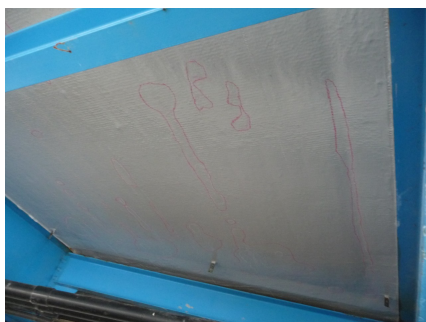
写真-8 スジ状の浮き
