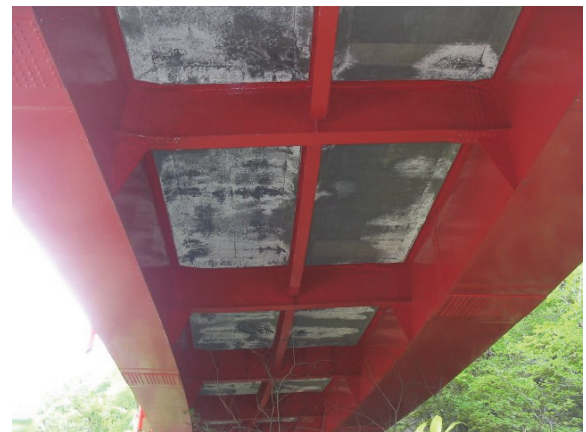
写真-1 ASR によるひびわれ損傷が確認された床版
