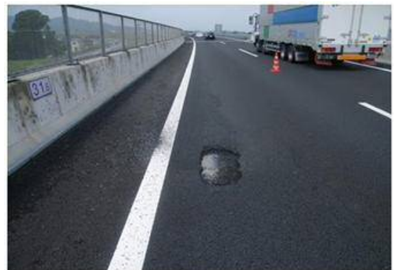
写真-1 橋面舗装の損傷例
