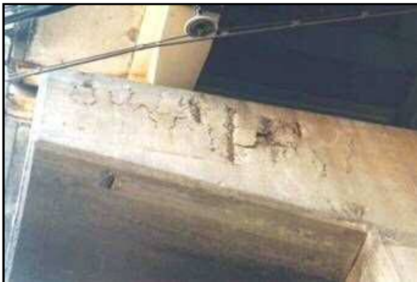
かぶり不足による腐食
