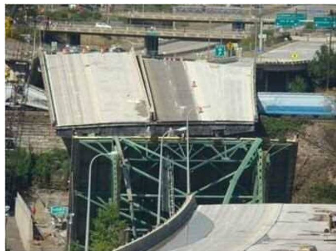
1格点の破壊による落橋
