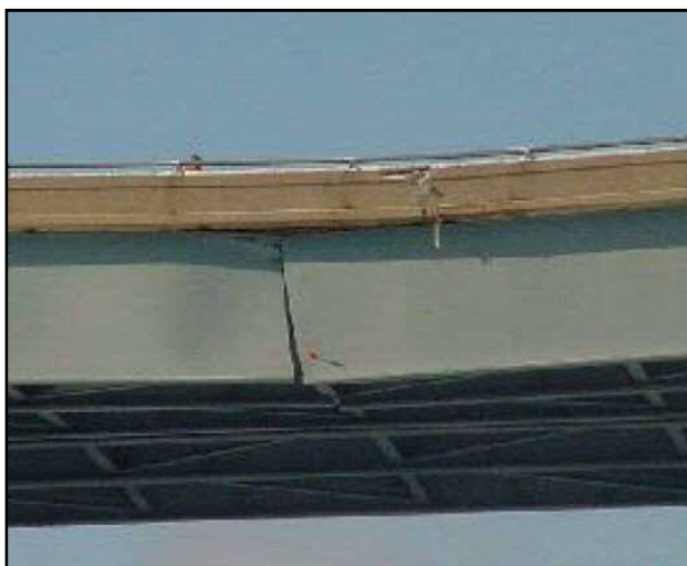
亀裂で主桁が破断した例
