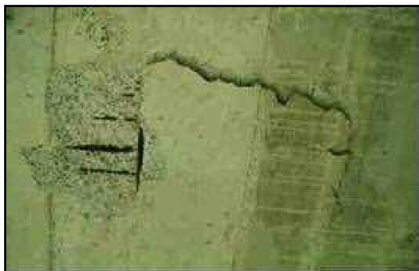
コンクリート片の落下
