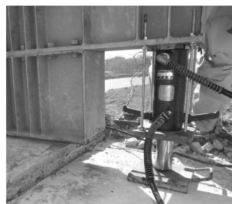
(2) ジャッキ扛上により桁とはく離
