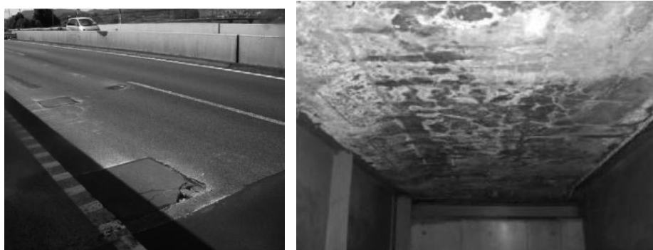
(1) ポットホールの発生と再劣化
