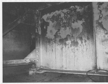
写真-1.4.5 火災による損傷事例 1)
