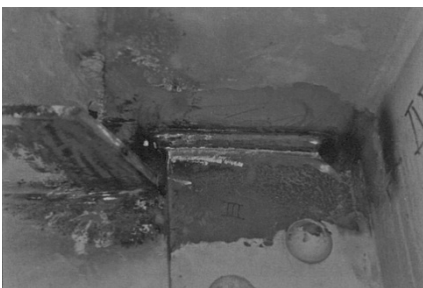
写真-1.4.7 疲労き裂の溶接補修事例 ③
