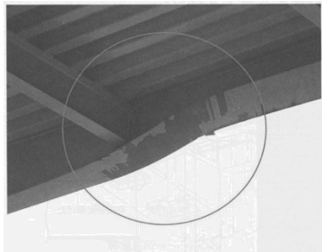
写真-1.4.4 車両衝突による損傷事例 1)
