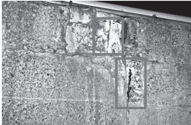
写真-1.3.10 コンクリートの剥離・鉄筋腐食
