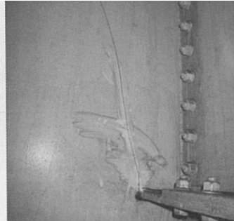
写真-1.4.2 疲労損傷事例 4)
