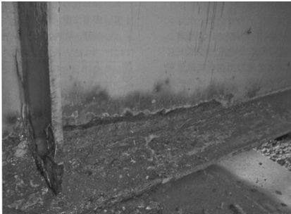
写真-1.4.1 桁端部の腐食損傷事例 3)
