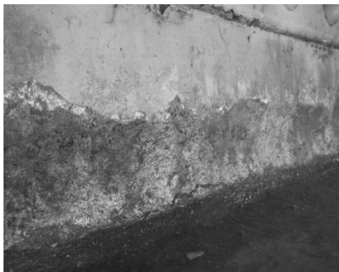
(1) 主桁ウェブとフランジ接合部の著しい腐食
