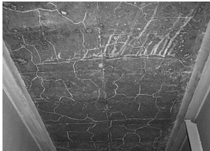
写真-1.3.8 コンクリート床版に発生したひび割れ
