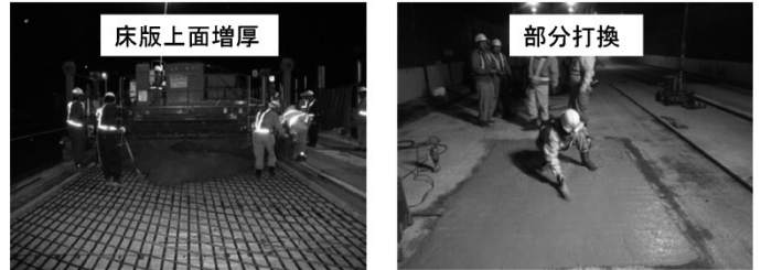
図-1.3.23 過去の補修・補強状況
