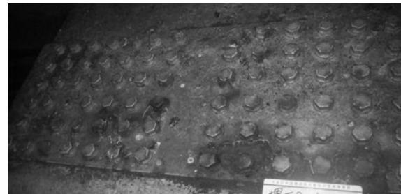
写真-9 添接板の腐食状況
