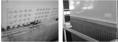
(a)鋼製橋脚基部の腐食
