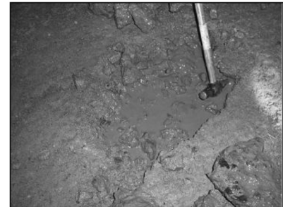
図-13 既設床版の土砂化
