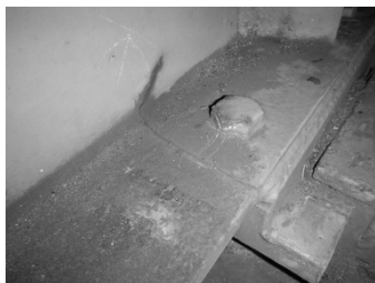
(1) 疲労き裂発生状況
