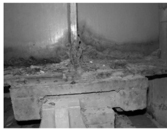
図-17 桁端部の腐食
