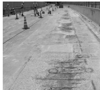
図-4 床版上面の変状
