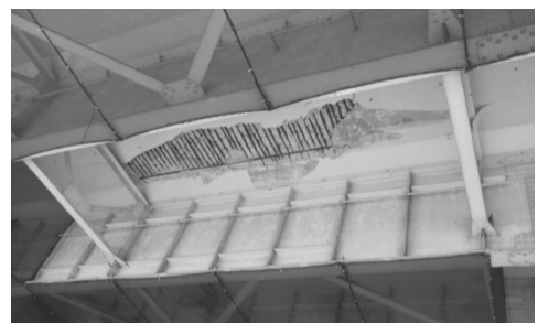
図-15 コンクリート塗装の剥離
