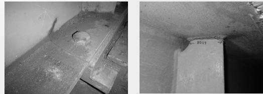
ソールプレート溶接部
