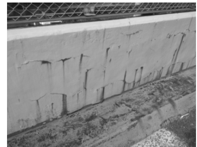
図-10 壁高欄の変状
