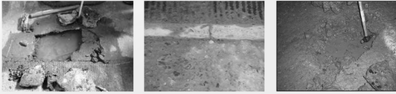
増し厚床版の変状 施工目地からの漏水 既設床版の土砂化
