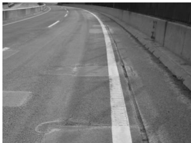
図-3 路面ポットホールの発生
