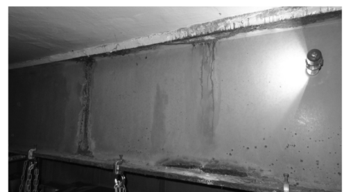
図-14 補強縦桁の腐食
