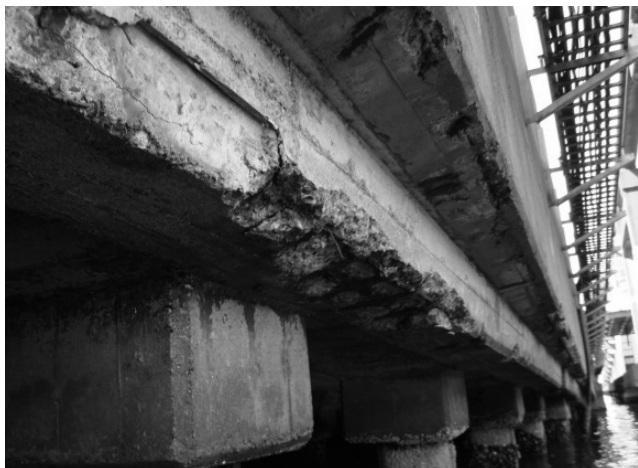
図-3 東品川栈橋の損傷状況
