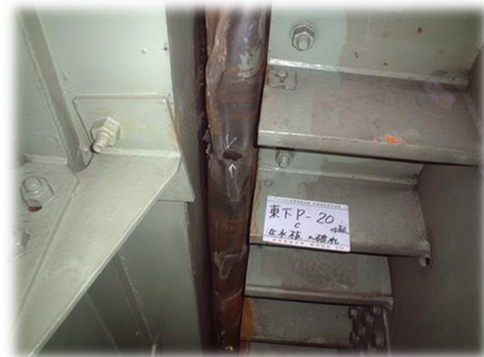
止水工(排水樋の破れ)
