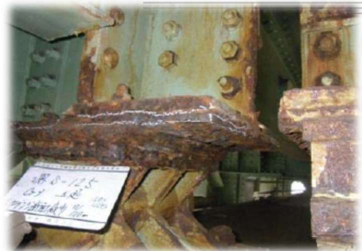
主桁端部下フランジの断面減少
