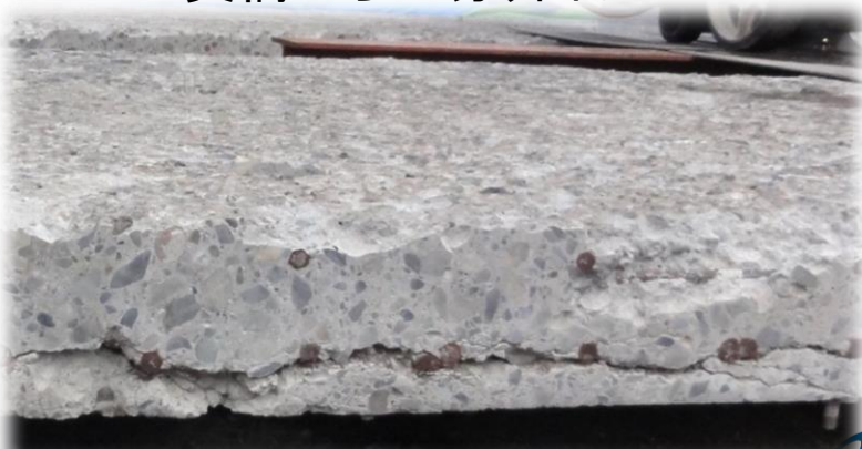
切り出し床版の水平ひび割れ
