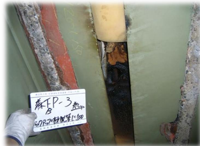
止水工(バックアップ材脱落)
