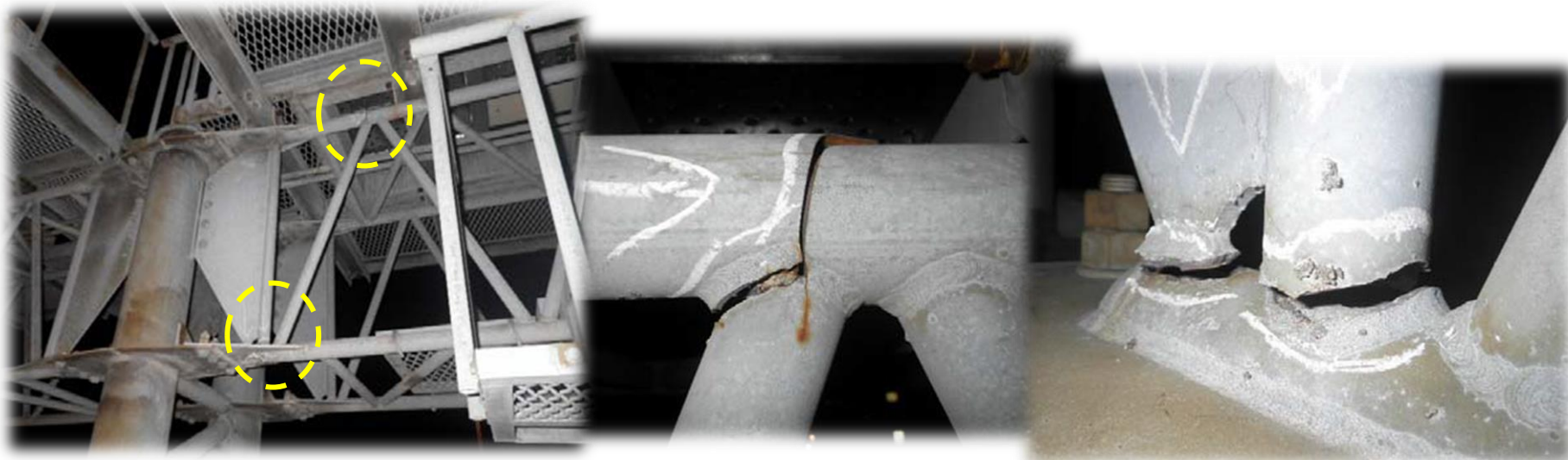
門構トラス材の破断
