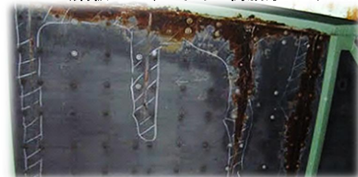
鋼板の浮き、はく離、腐食、漏水
