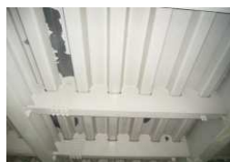
鋼床版表面の塗膜剥離
