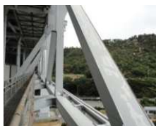
上塗りの剥離
