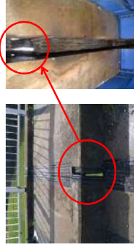
伸縮装置の損傷状況
