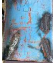
横桁の腹板クレーク
