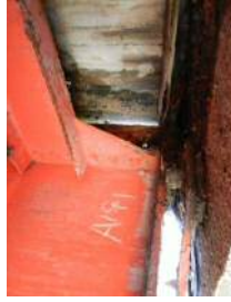
支承の腐食状況
