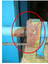
排水管の腐食状況
