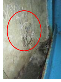
床版下面のうき・剥離
