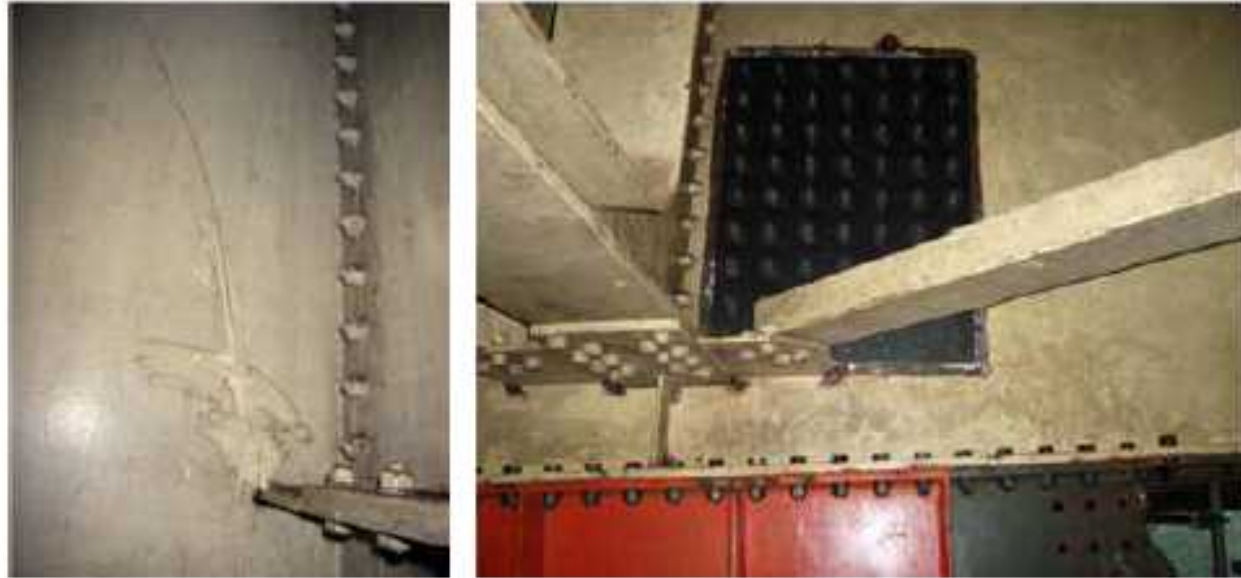
①主桁ウェブに大きく進展したき裂（左）と緊急措置の補強材設置例（右） 10)
