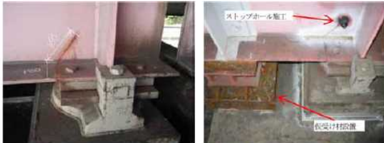
②支承ソールプレート部の損傷（左） 11)と緊急措置の例（右） 12)
