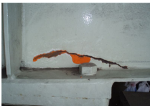
写真 4.6 外面からのき裂状況
