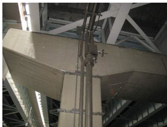
写真 3.4 作業足場と干渉する配管類
