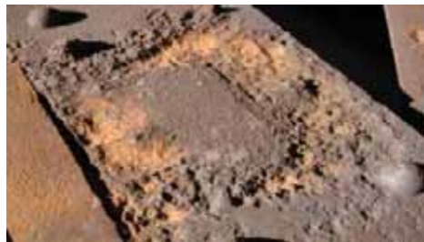
まくらぎ下の腐食
