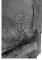
P4-P5張出部路肩側 浮き
