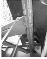
P8-AP9(G2-G3) 対橋構 腐食
