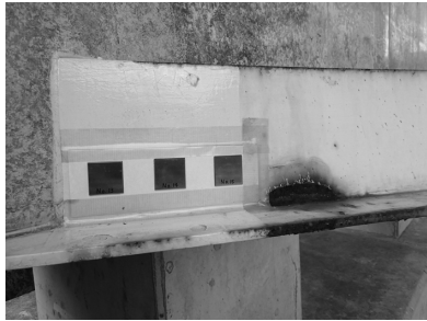
図-6 ワッペン試験片による腐食計測
