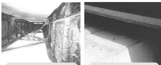
内桁部 (層状剥離さび)
