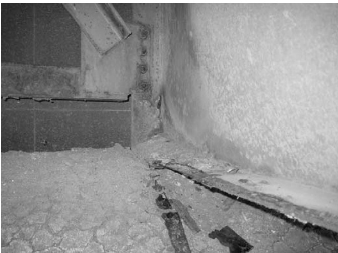
写真-7 蟻塚のある橋台と著しく腐食した桁端部
