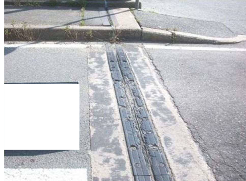
フェイスゴムの破損
