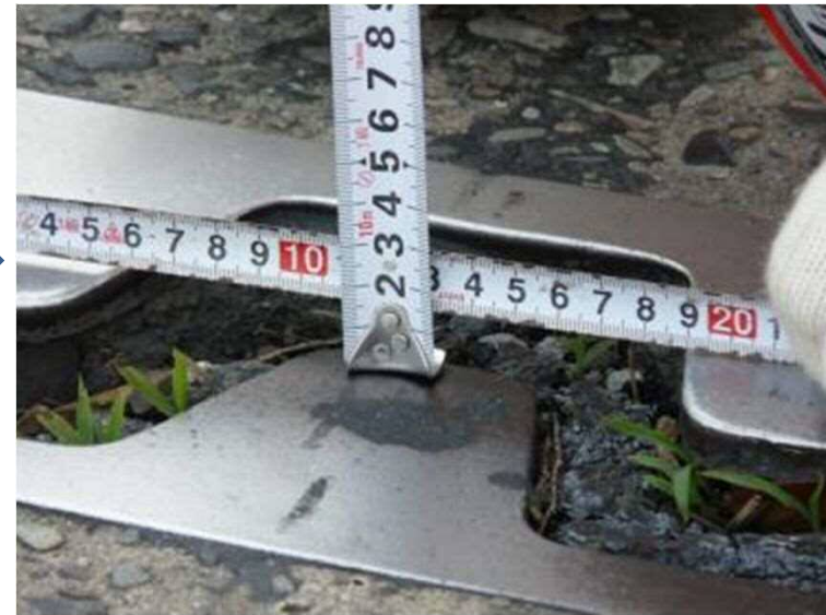
伸縮装置に段差の発生
