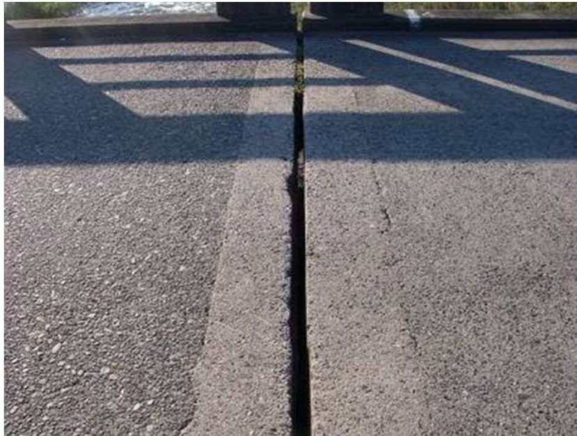
目地材の脱落
