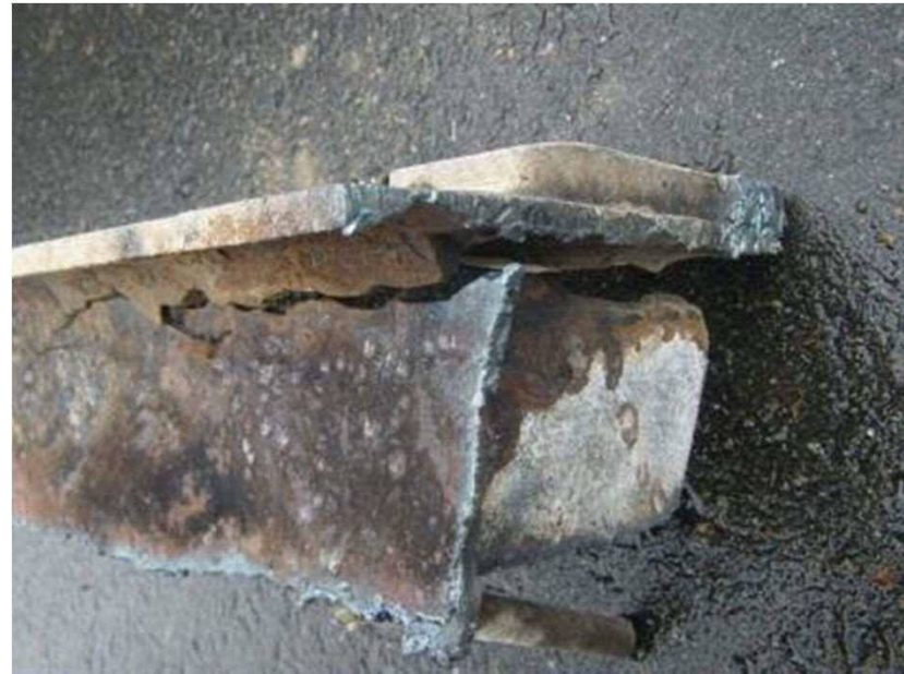
リブプレート破断
