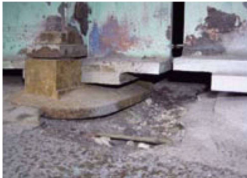
支承の荷重支持機能の低下
