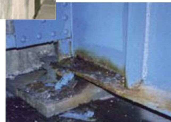
鋼部材の腐食
