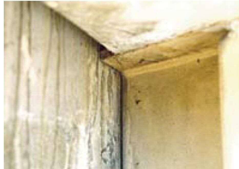
橋台と主桁の接触
