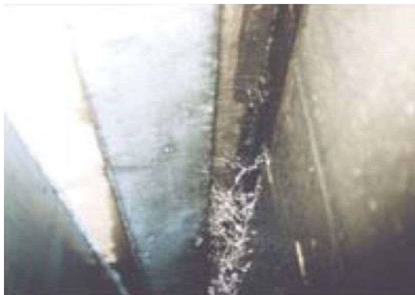
伸縮装置からの漏水
