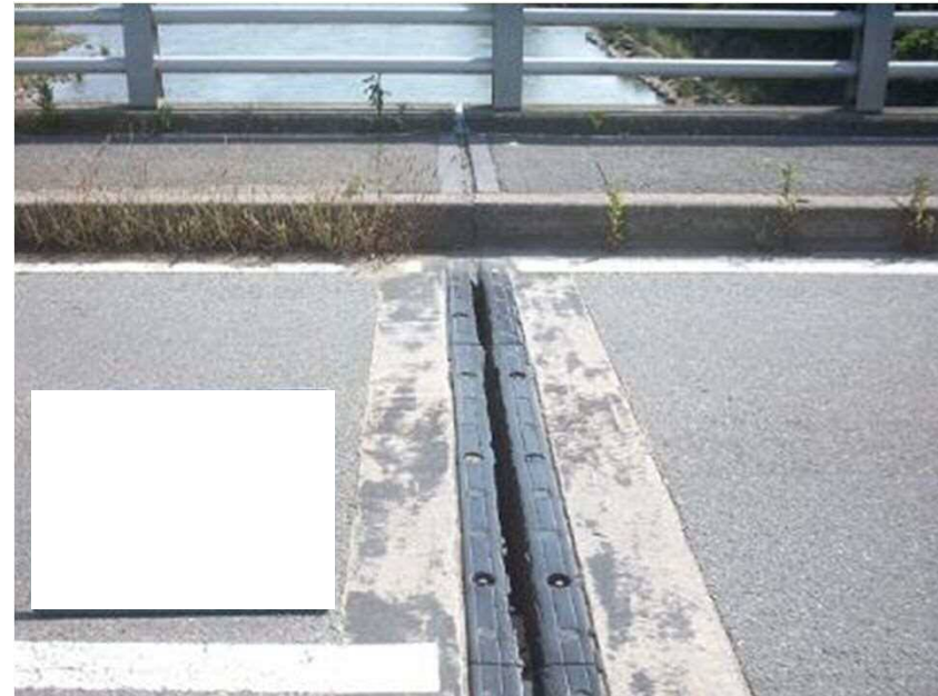
目地部の破損・脱落
