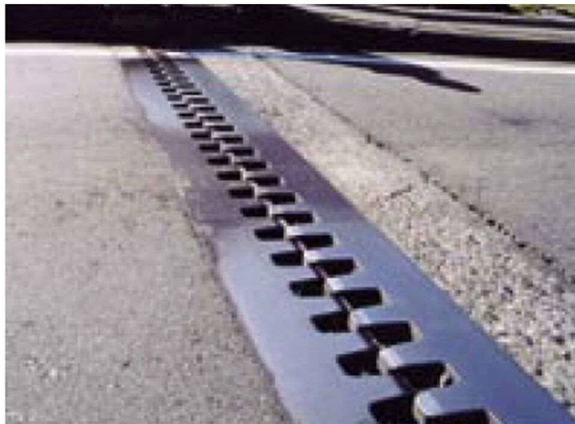
床版側の沈下による段差
