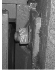
アンカーボルトのゆるみ
