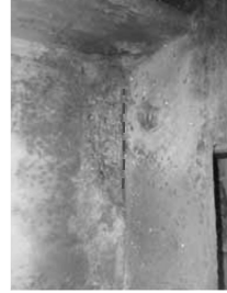
ウェブと下フランジ溶接部の亀裂
