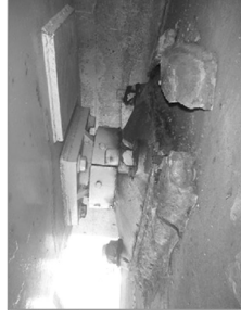
沓座モルタルの破損
