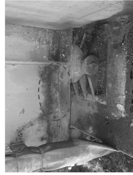
下フランジの変形
