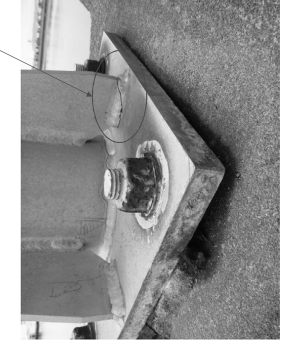
照明柱基部の亀裂
