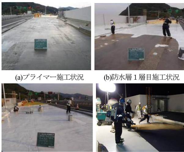
(a) プライマー施工状況 (b) 防水層 1 層目施工状況 (c) 防水層 2 層目施工状況 (d) 接着層施工状況
