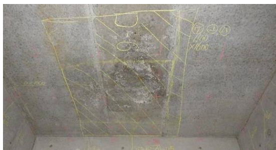
写真-2 床版下面の劣化状況
