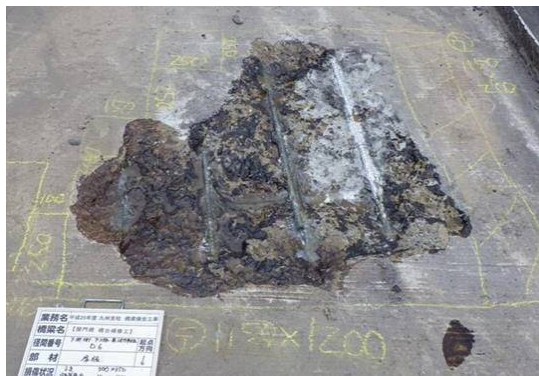
写真-1 床版上面の損傷状況
