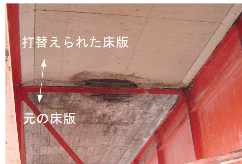
写真-1 床版打継目付近の抜け落ち 1)
