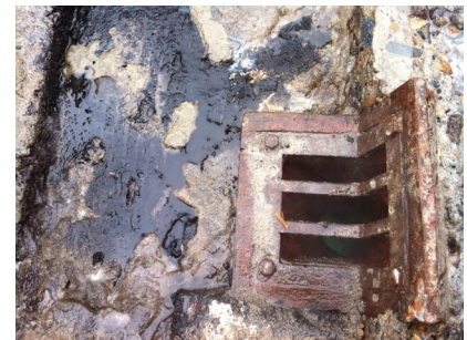
(c-2)排水マス近傍における床版防水層の剥離 (舗装撤去後)
