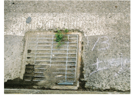
(b-1)排水ますの土砂詰り
