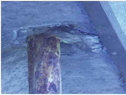
(a-1)漏水とこれに伴うコンクリートの劣化および排水管の腐食
