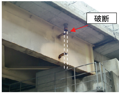
(a-2)腐食による排水管の破断
