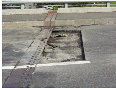
(c-1)伸縮装置近傍における床版防水層の剥離 (舗装撤去後)
