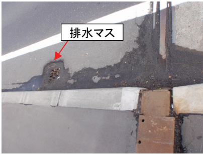
(b-2)排水ますの土砂詰りとそれに伴う周辺の滞水および土砂堆積
