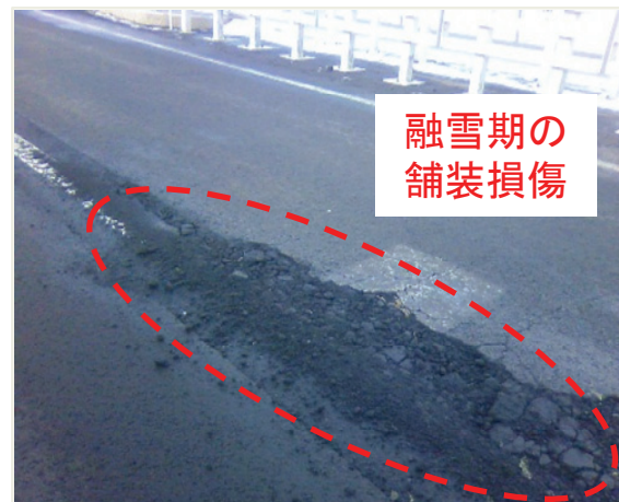
写真-1 積雪寒冷地における融雪期の舗装損傷
