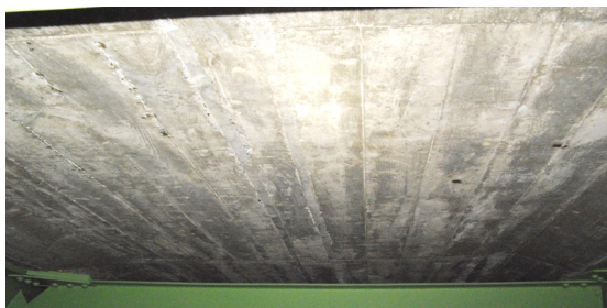
写真-1 撤去前の RC 床版下面の状況
