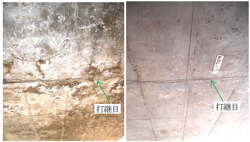
(a) As 舗装なし (b) As 舗装あり 写真-6 水張り後 3 箇月目の床版下面
