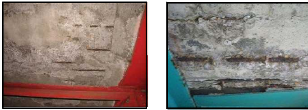
(1)鉄筋露出 (2)塩害によるはく離
