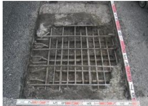
写真-4 RC 床版上面における損傷
