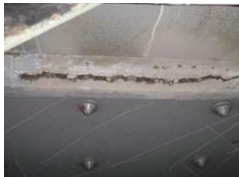
写真-5 床版下面の損傷
