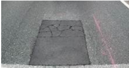
写真-2 緊急補修後の損傷
