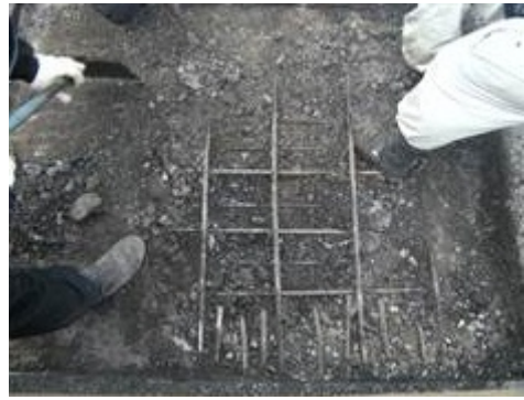
写真-3 床版コンクリートの骨材化
