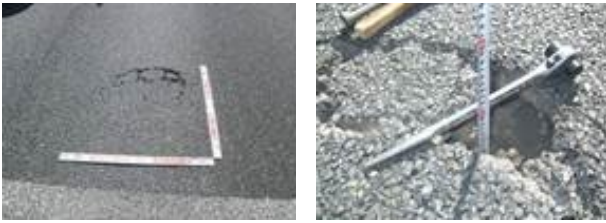
写真-1 日常点検時の損傷
