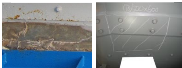
貫通ひびわれ
