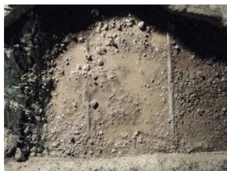
図 3.2 既設床版上面の土砂化近景
