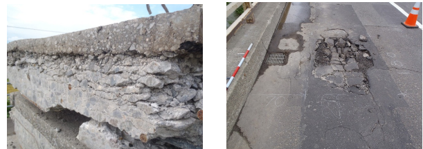
(1) 床版の層状剥離状況 (2) 床版の陥没に伴うアスファルトの損傷状況
