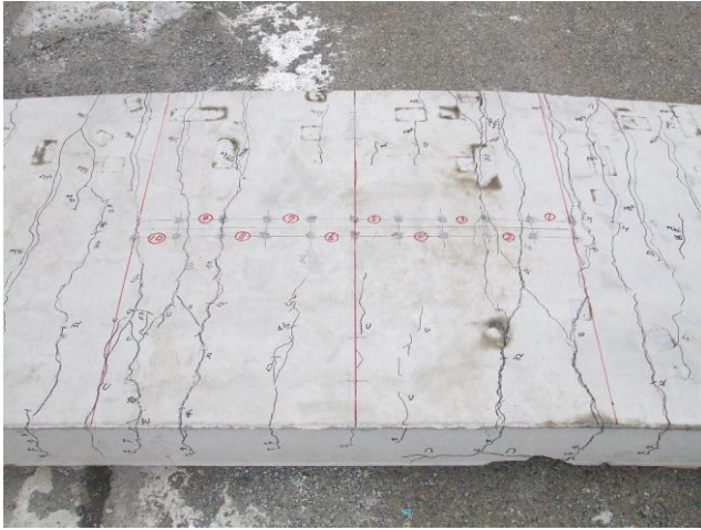
写真-2 実験終了後のひび割れ性状 (C1 供試体)
