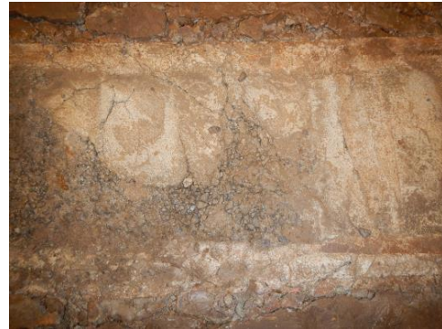
写真-6 床版 III 上面の砂利化
