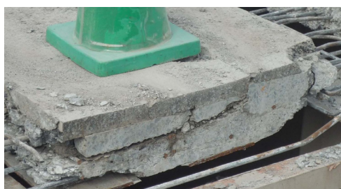
写真-2 部分補修部の再劣化事例
