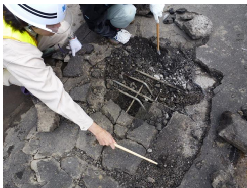
写真-1 北海道における RC 床版の陥没事例
