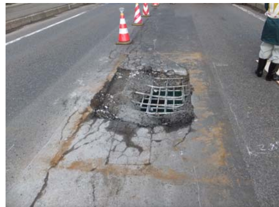
写真-1 抜け落ち損傷状況 (橋面)
