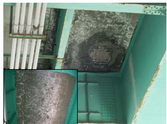
写真-2 上面土砂化及び抜け落ち箇所の床版下面状況
