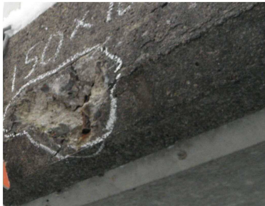
地覆の剥離・鉄筋露出
