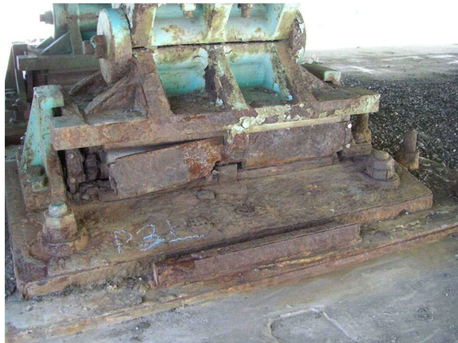
支承のカバープレート腐食・脱落 (伸縮装置からの漏水による)
