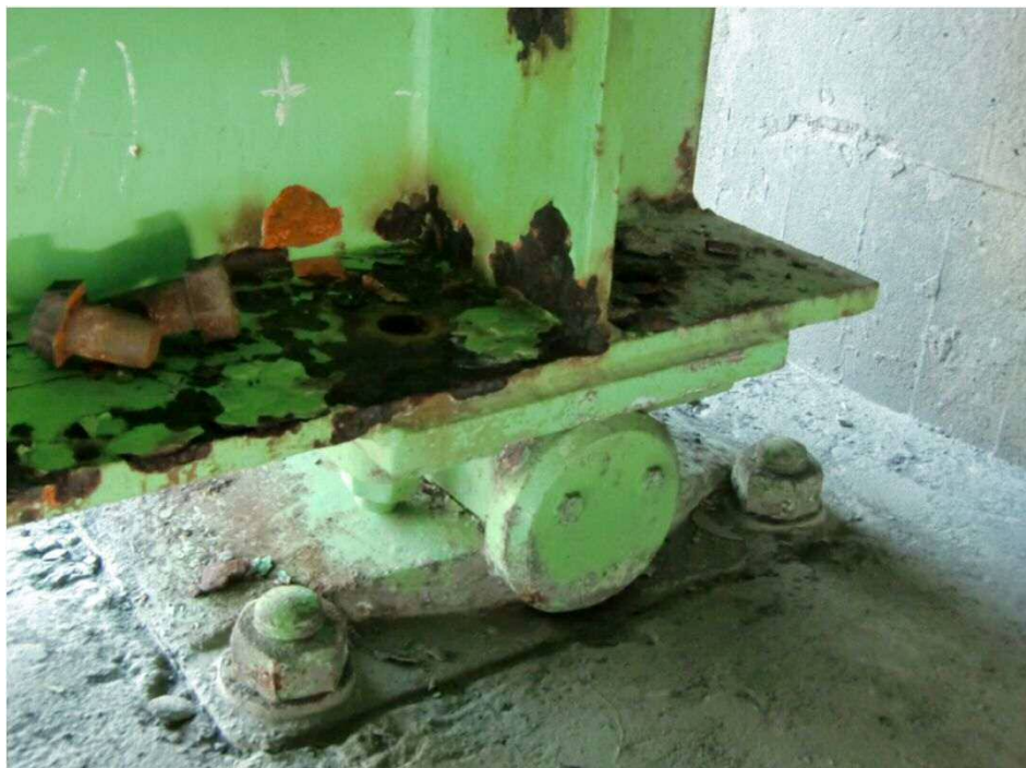
支承のボルト破断・脱落 (震災による)
