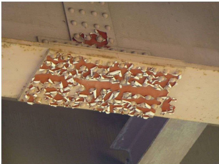
塗膜の劣化 (添接部が先行)
