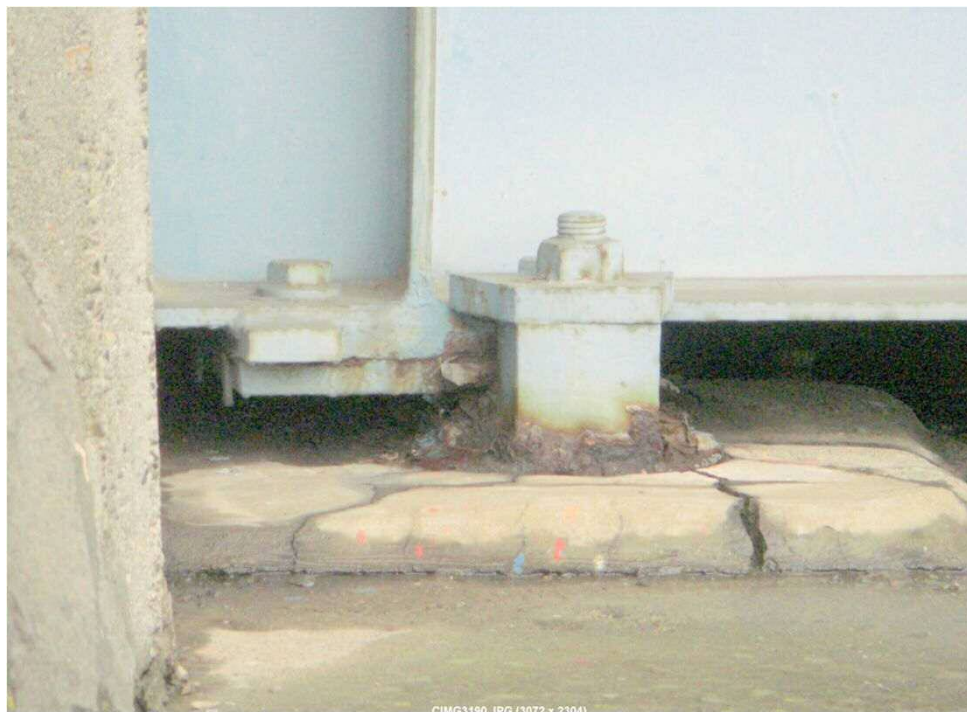
支承遊間異常 (桁端も遊間無し)
