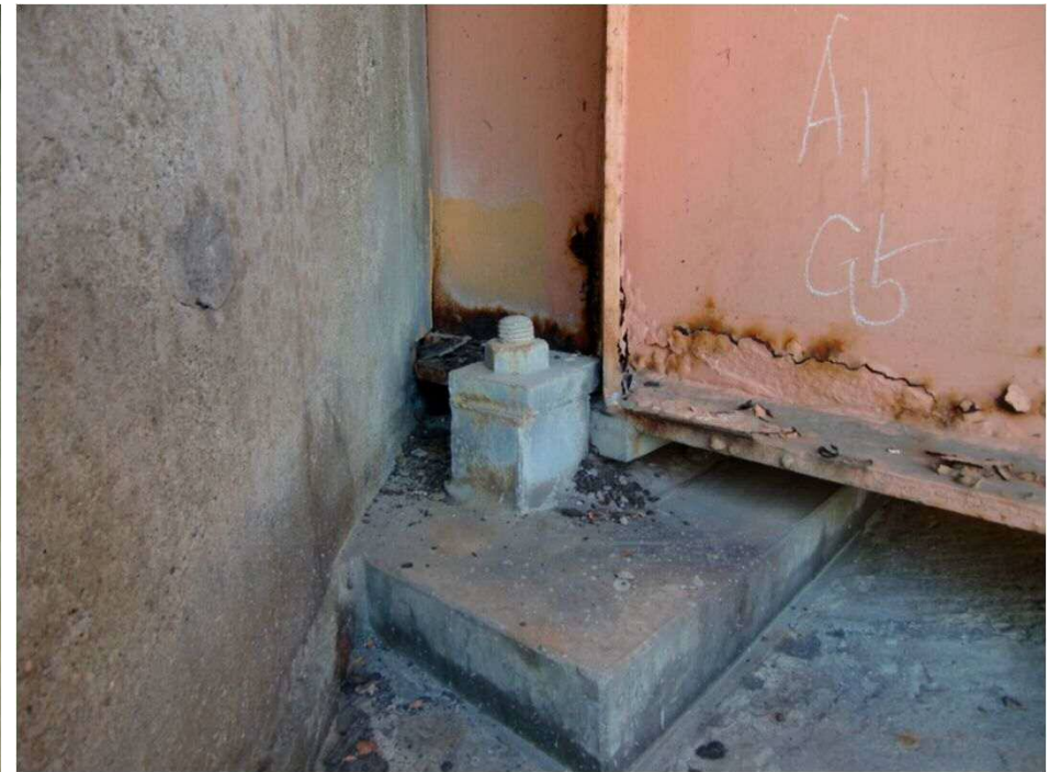
桁遊間の異常 (遊間無し)
