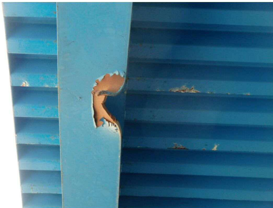
側道橋下フランジ変形・欠損 (車両衝突、桁下クリア4m程度)
