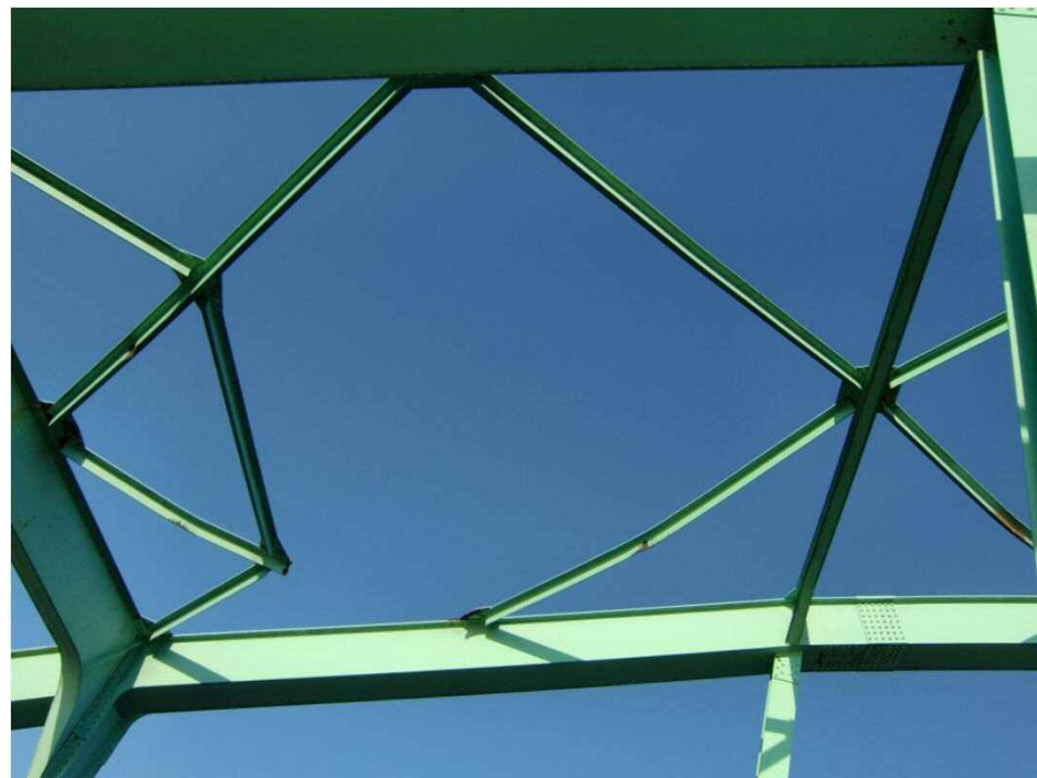
トラス橋上横構脱落 (地震力による破断)
