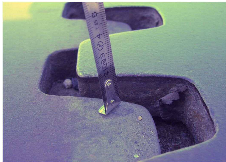
伸縮装置段差 （沓座モルタル損傷による）
