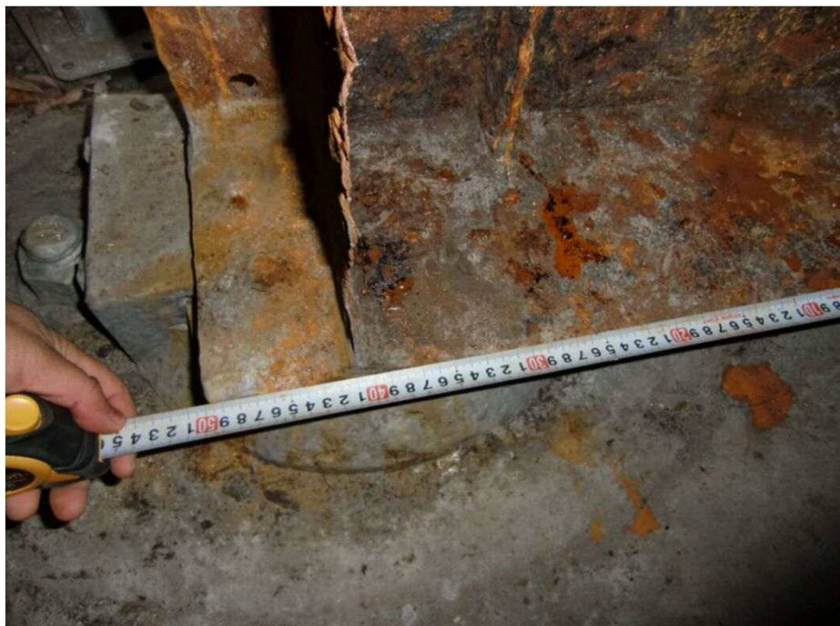
腐食大 (伸縮装置漏水による腐食)
