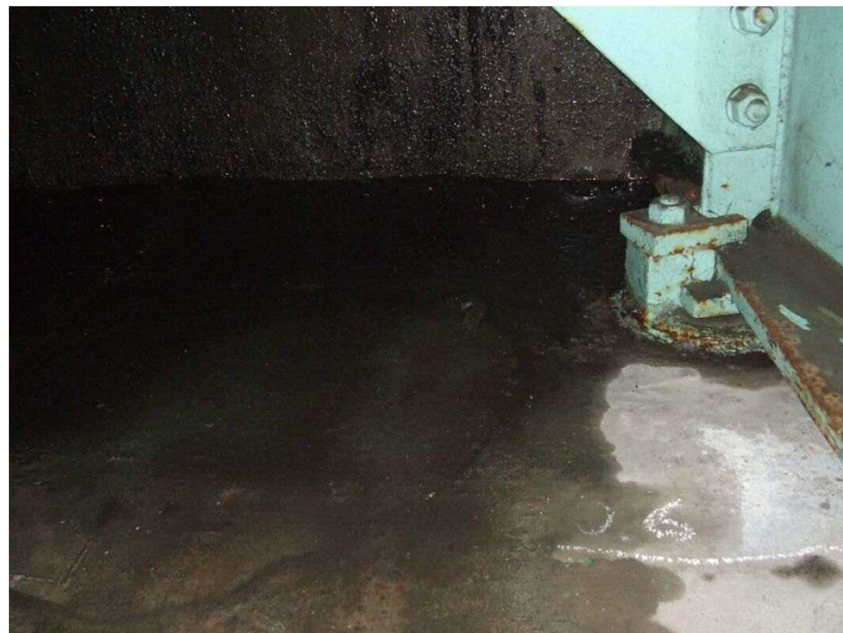
支承周り滞水 (伸縮装置の漏水による)
