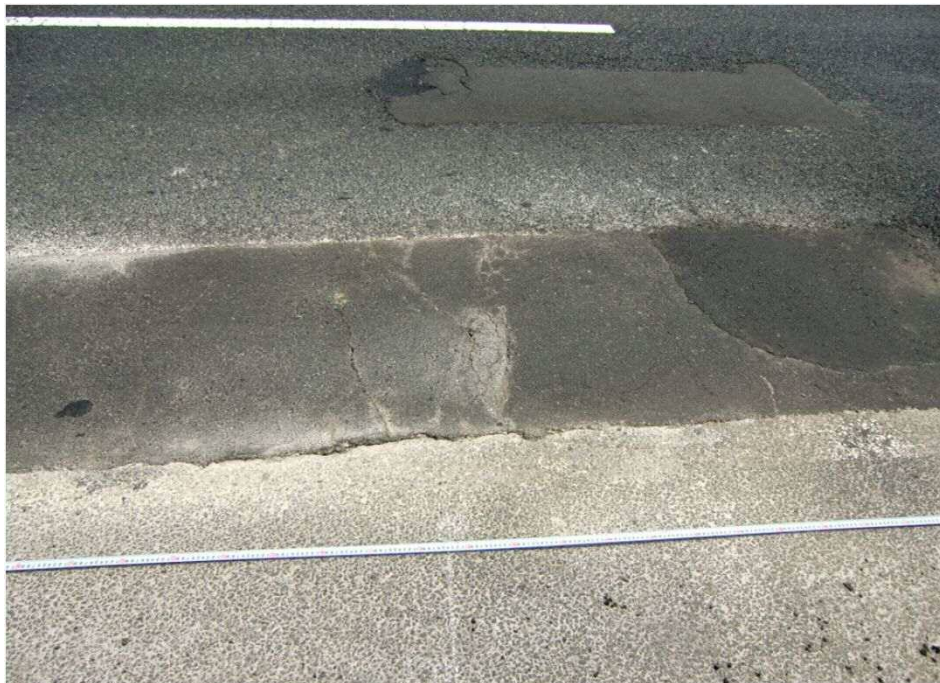
舗装補修跡(ポットホール多発) (床版上面が土砂化していた)
