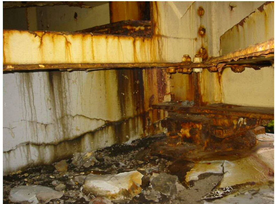
支承の腐食大 (桁端も腐食)
