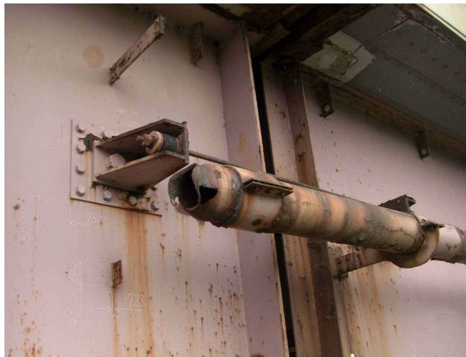
排水管腐食・脱落 (塩害による腐食)
