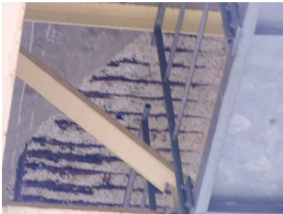
コンクリート床版剥離・鉄筋露出 (かぶり不足)
