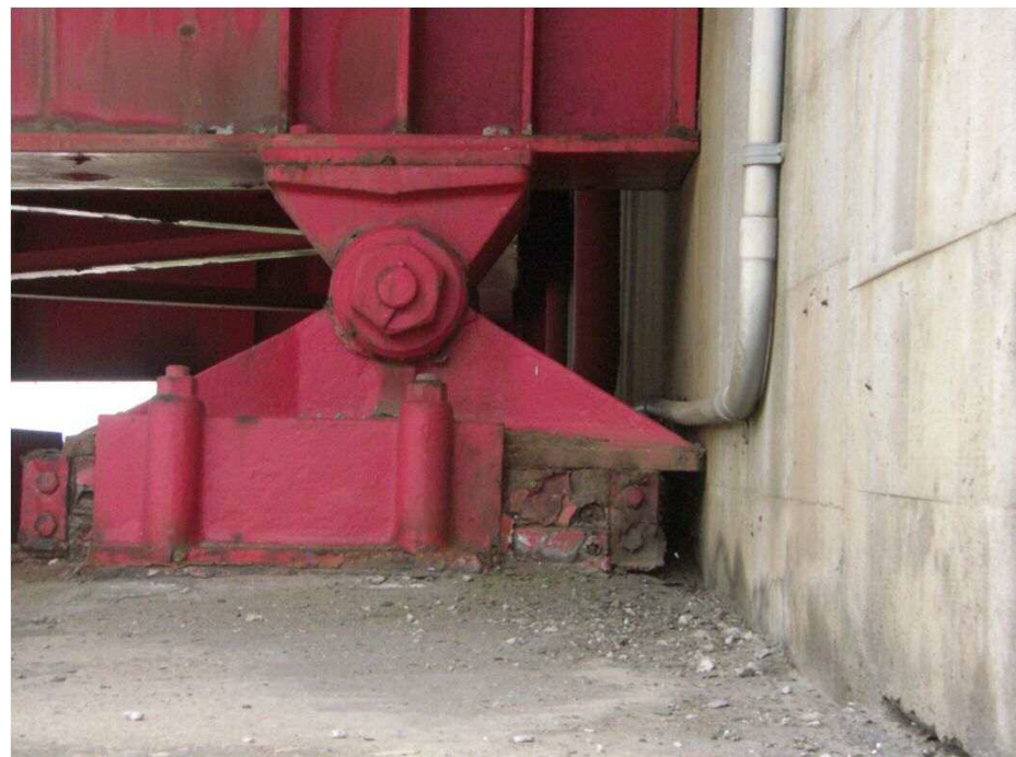
支承遊間異常 (桁端も遊間無し) (反対側(固定)アンカーボルト変形)
