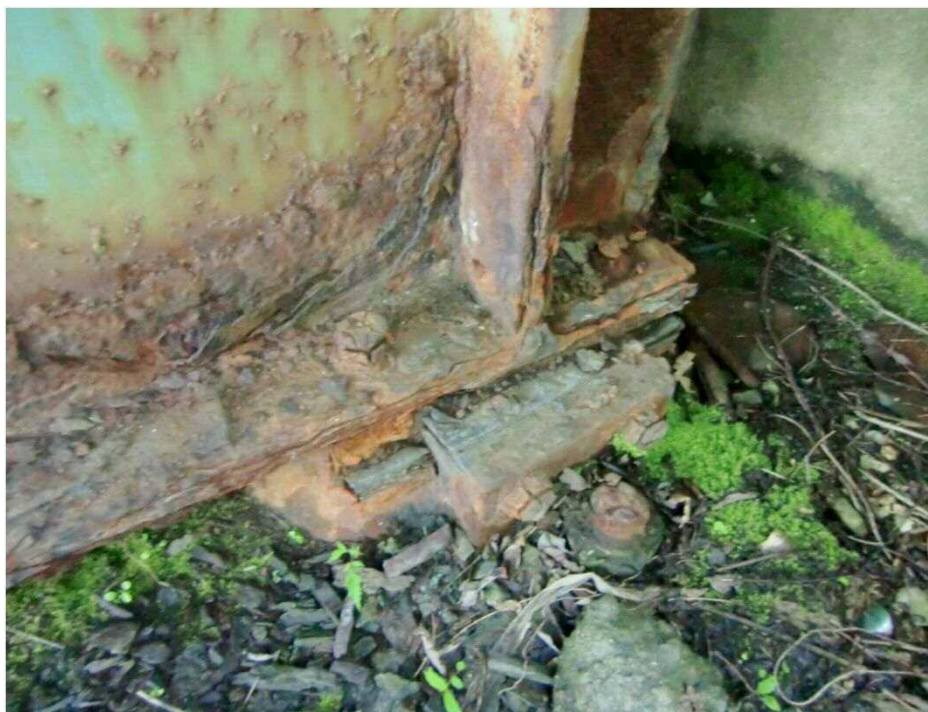
支承土砂詰まり (腐食進行)
