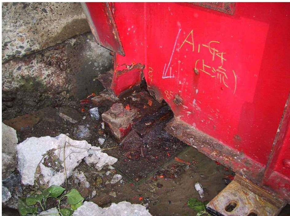
主桁端部変形 (地震力による局部座屈)
