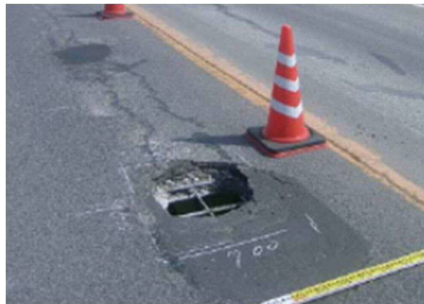
床版抜け落ち (床版上面から)
