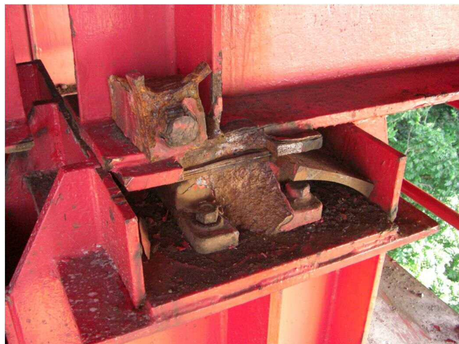
震災による支承の破断・脱落 (サイドストッパー破断)
