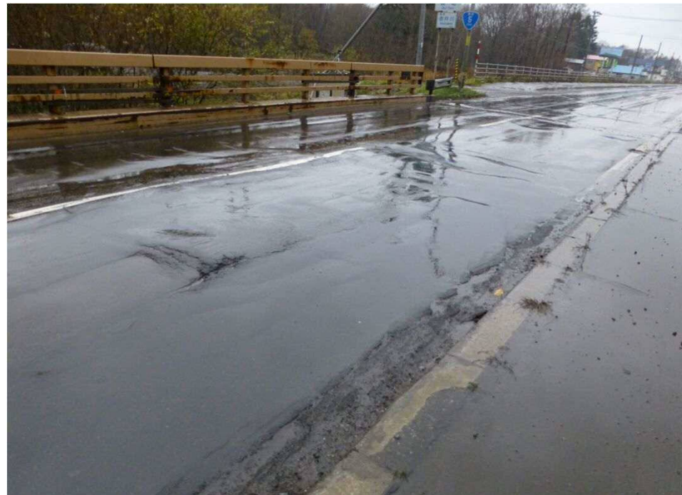
舗装補修跡(ポットホール多発) (橋梁床組みの剛性不足)
