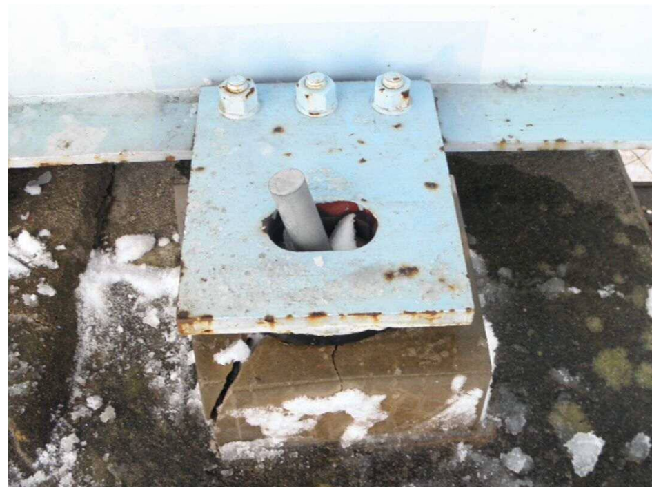
変位制限装置(アンカーバー)変形 及びコンクリートブロックひびわれ (震災による)
