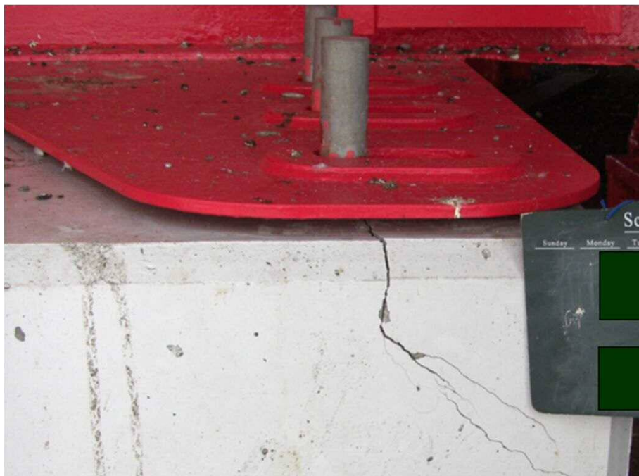
変位制限装置(アンカーバー)変形 及びコンクリートブロックひびわれ (変位制限装置遊間不足による)
