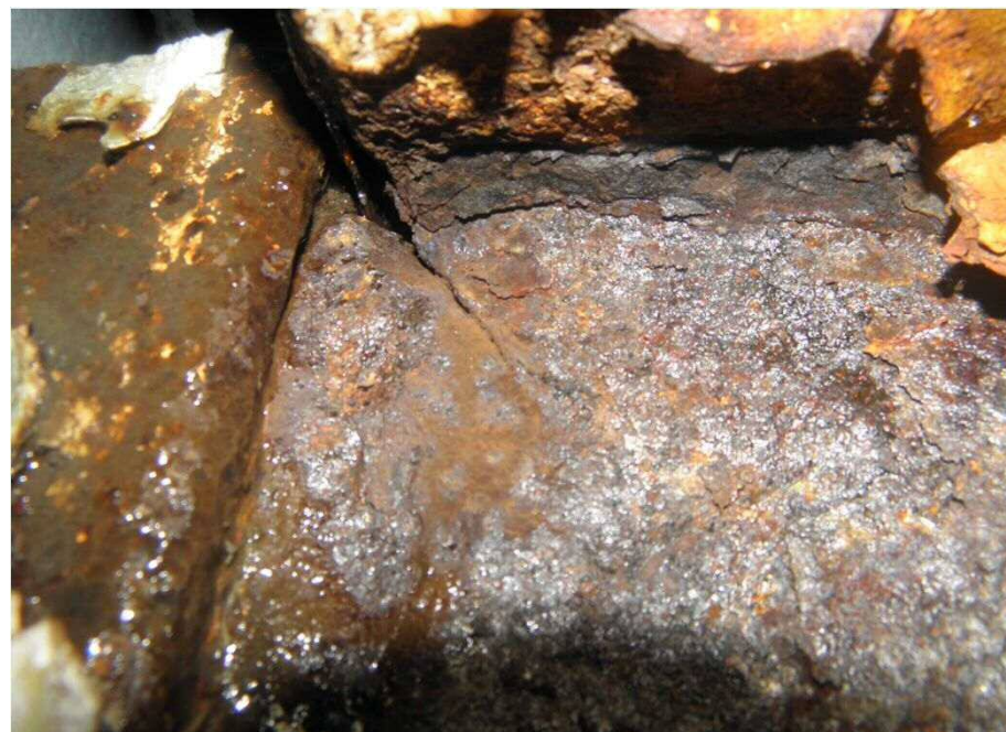
疲労亀裂 (左写真の拡大)
