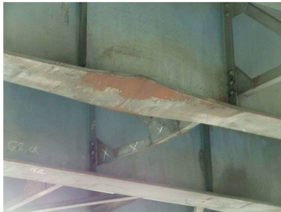
本線橋下フランジと対傾構の変形 (車両衝突、桁下クリア5m程度)
