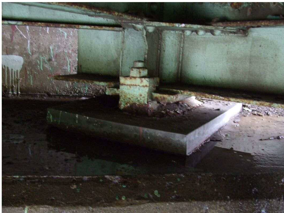
伸縮装置からの漏水の例
