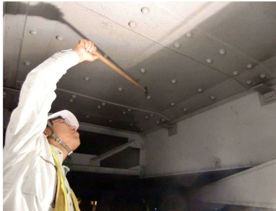
RC床版下面補強鋼板のうき (たたき点検で確認)
