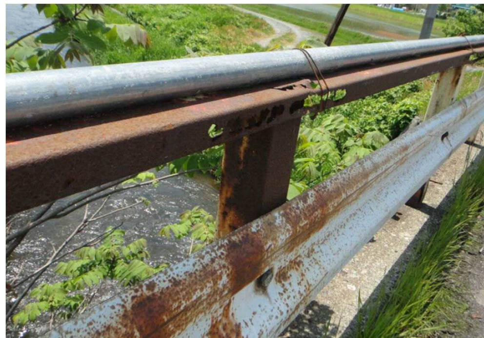
防護柵腐食大 (上段レール破断、応急処置済)
