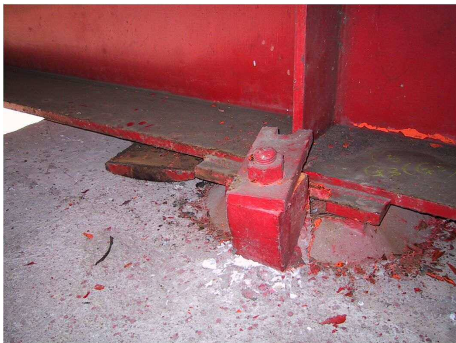
震災による支承の破断・脱落 (ベアリングプレート脱落) (サイドストッパー破断)
