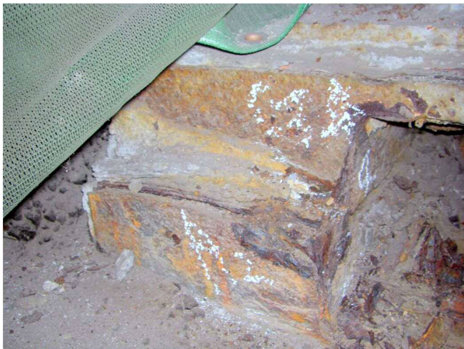
支承機能障害
