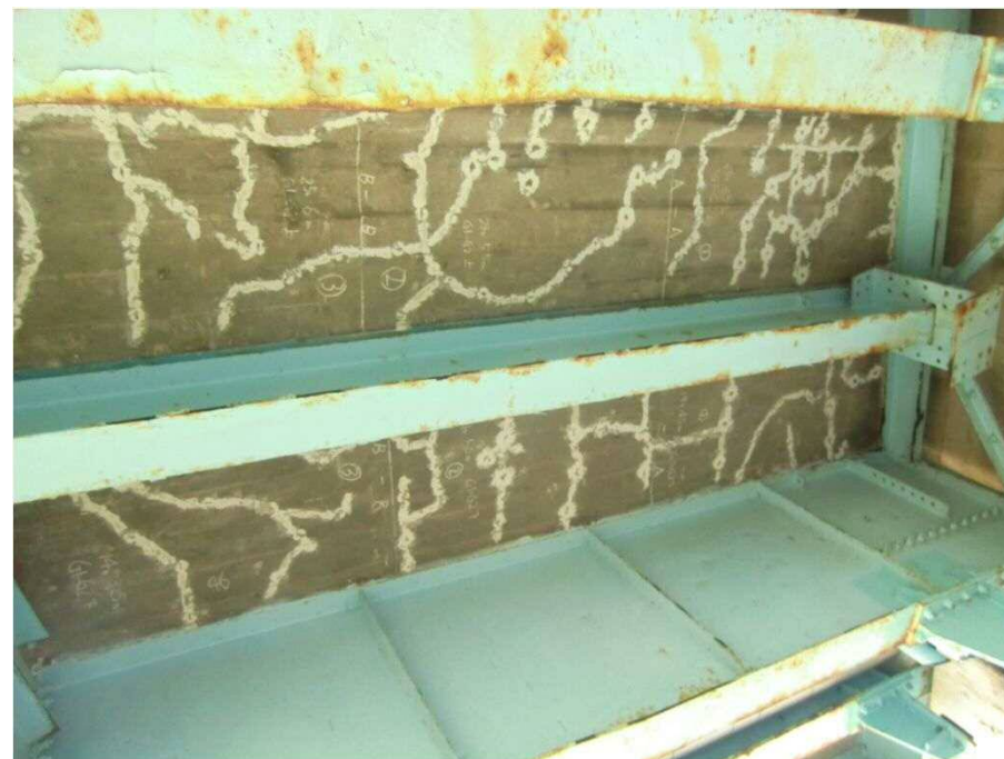
床版ひびわれ、遊離石灰 （活荷重疲労による） 注）ひびわれ注入補修済
