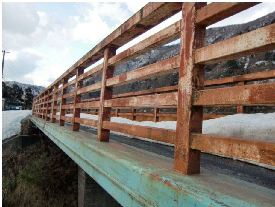
防護柵腐食小 (全体に腐食)
