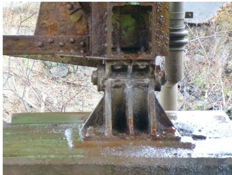
腐食大 (伸縮装置漏水による腐食)
