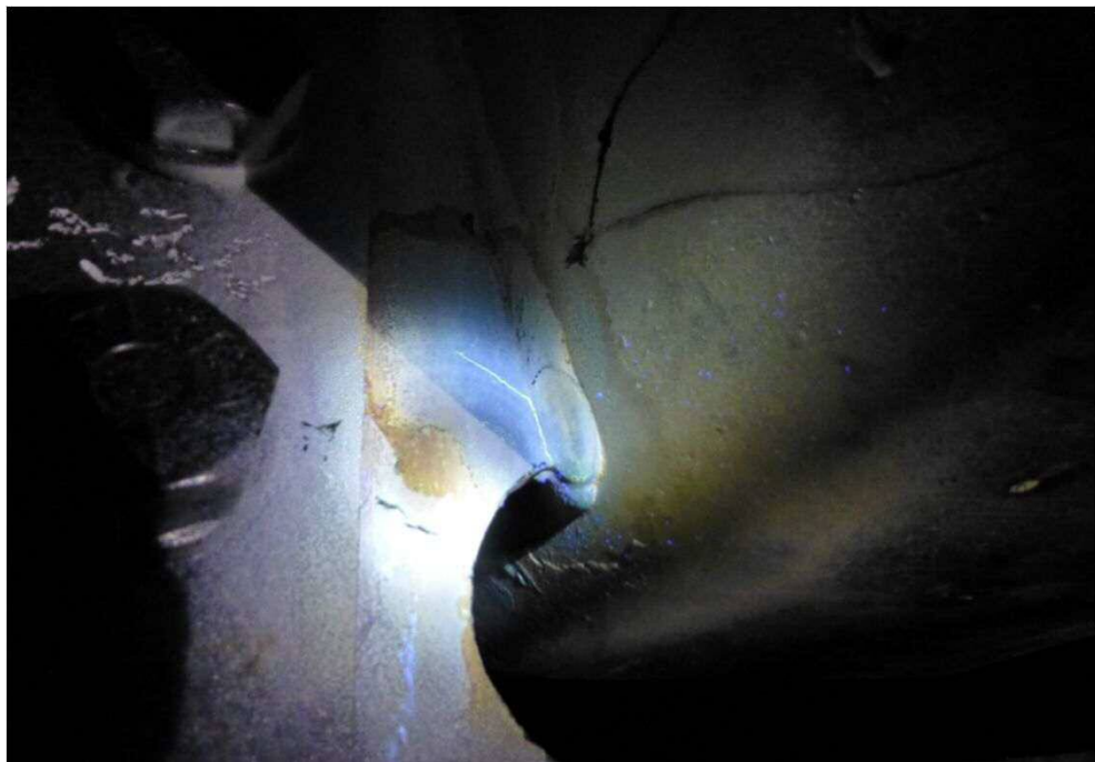
鋼床版疲労亀裂 (磁粉探傷試験による調査)
