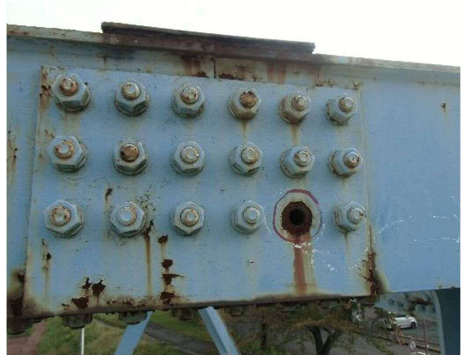
高力ボルト(F11T)の脱落 (下路トラス上弦材)
