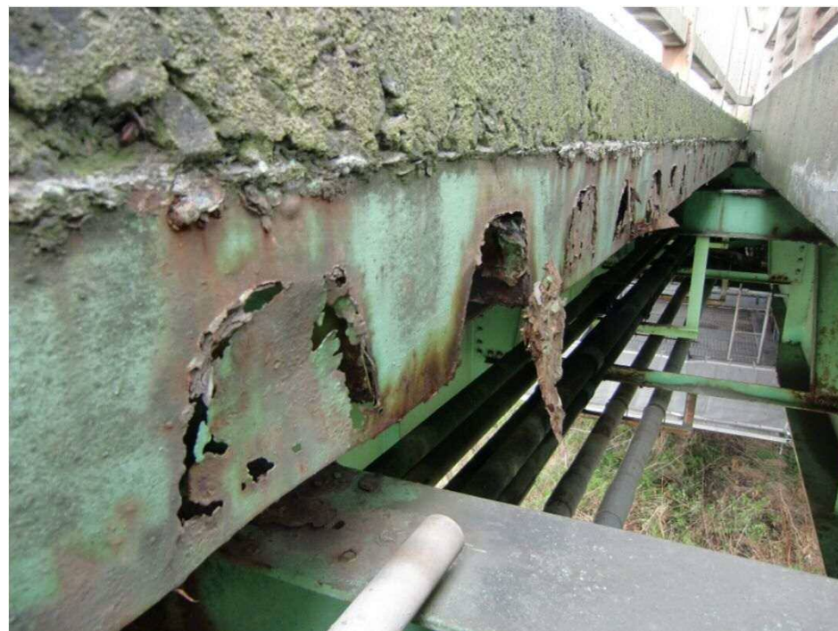
隣接橋からの塩水跳ね 上げによる塩害の例
