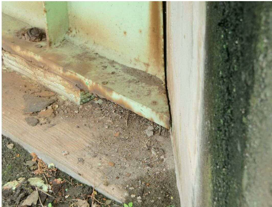
桁遊間の異常 (遊間無し)
