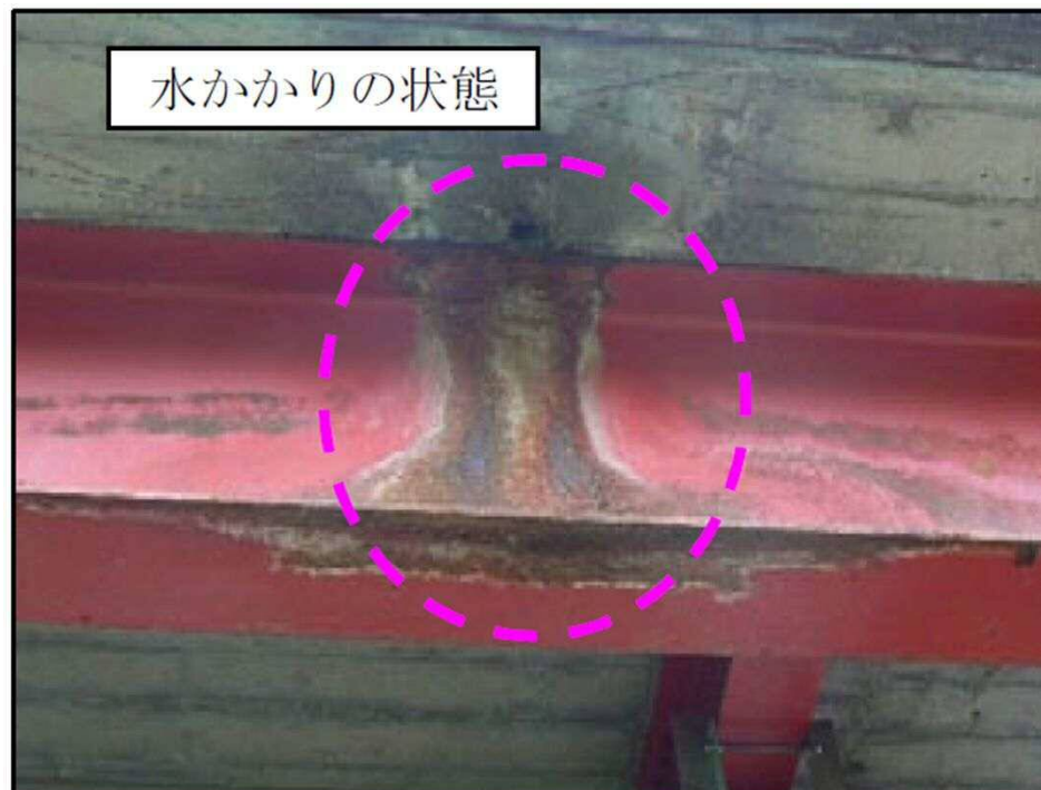
スラブドレーン流末不良の例
