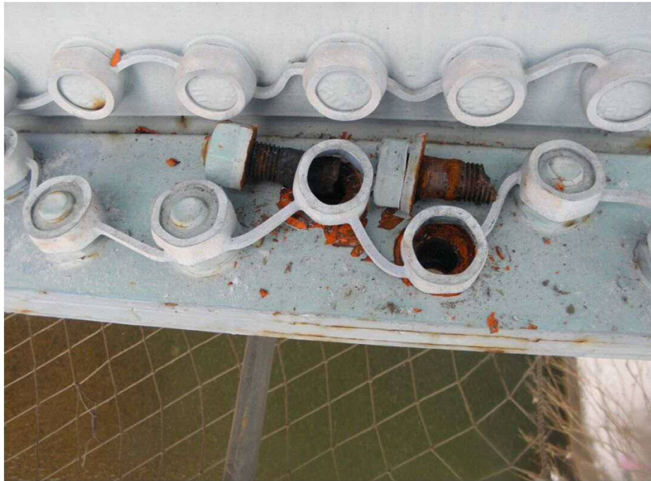
高力ボルト(F11T)の脱落 (鈑桁下フランジ) 注)脱落防止キャップ装着
