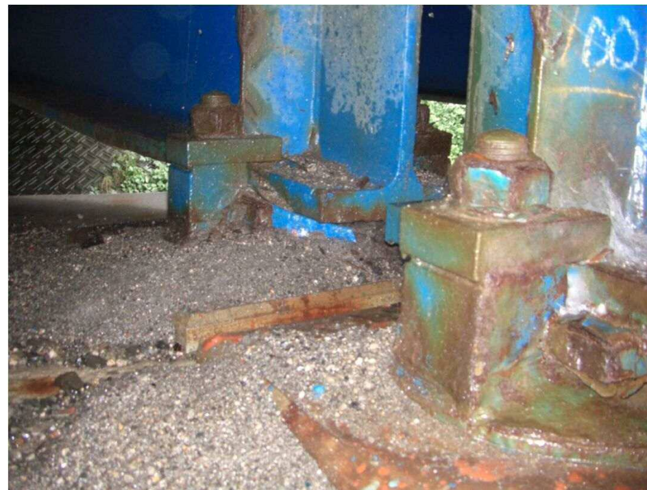
支承土砂詰まり (腐食進行)
