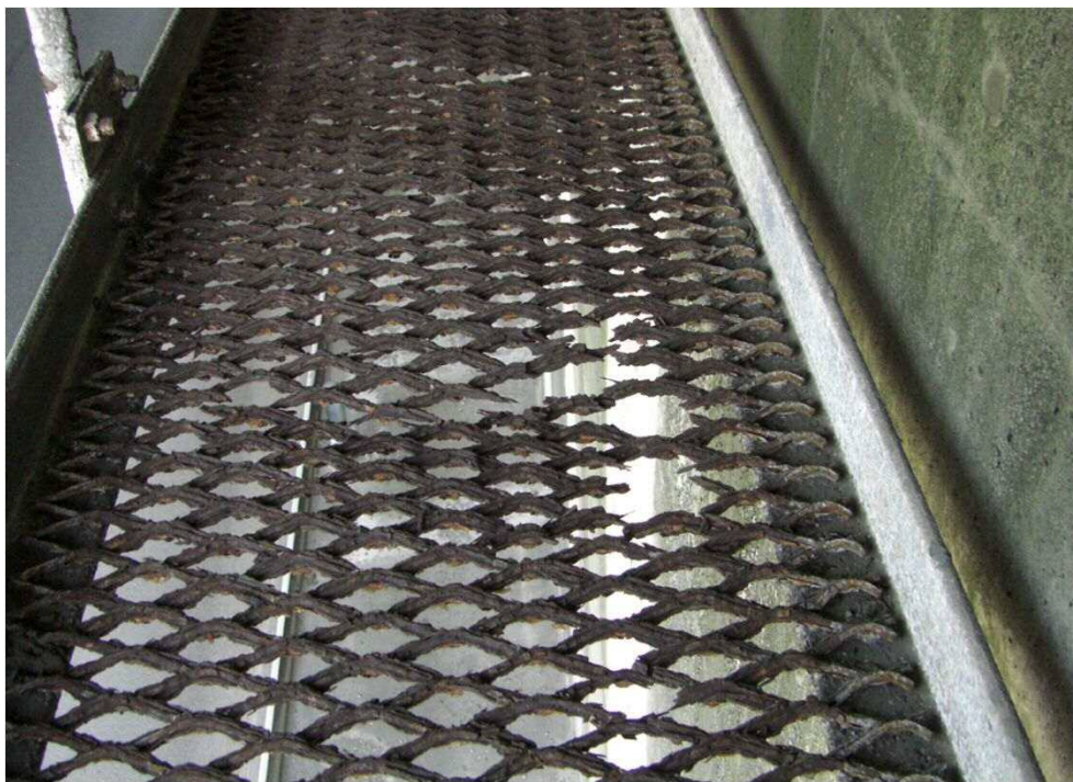
検査路腐食・破断 (塩害による腐食)
