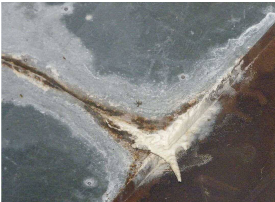
RC床版下面鋼板の腐食 (RC床版のひびわれによる)
