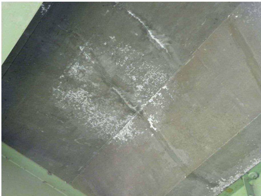
床版ひびわれ、遊離石灰 （乾燥収縮などによる）
