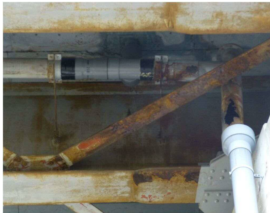
塗膜の劣化 (排水管損傷部周りが先行)
