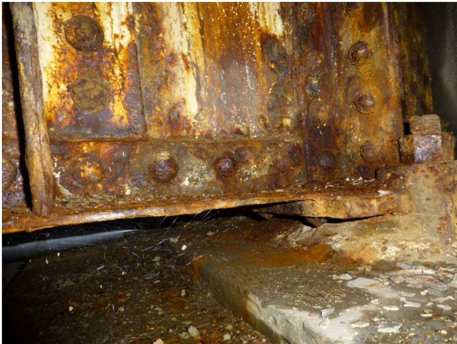
支承の腐食大 (桁端も腐食大)
