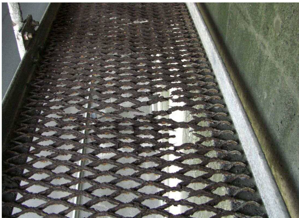
路下道路からの塩水跳ね 上げによる塩害の例
