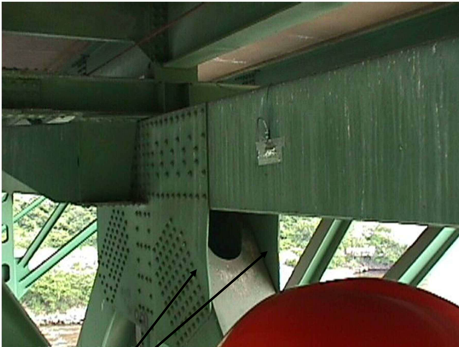
ガセットプレートの変形
