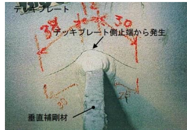
疲労き裂の例
