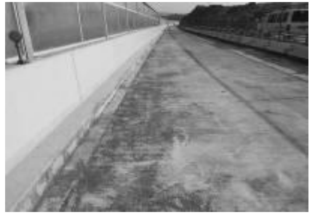
写真-3 残存するタックコートの状況
