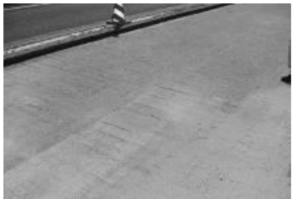
写真-5 床版面のひび割れの状況
