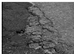
(2) 舗装の損傷及び凍害
