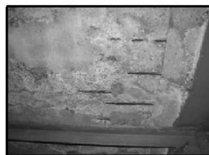
(2) 2方向ひびわれと遊離石灰
