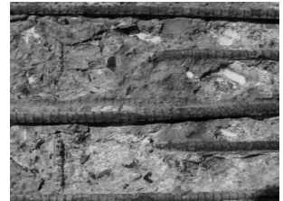
(1) 砂利化によるかぶりコンクリートの損傷
