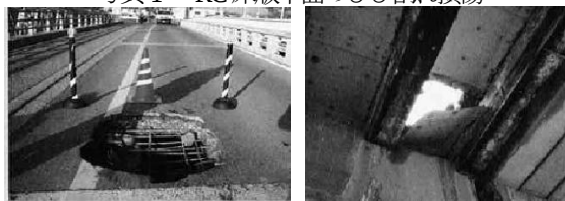
写真2 鋼板接着補強床版の抜け落ち例 留すると床版に影響を及ぼすとされる。
