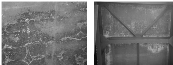
写真1 RC床版下面のひび割れ損傷
