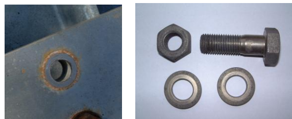
(a) アルミニウム板 (b) ボルトセット（腐食除去後） 写真-14 取り外し後の状況（試験体 I-1, 普通ボルト）
