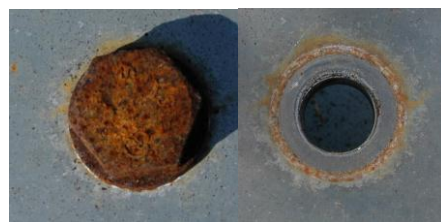
写真-1 異種金属腐食例
