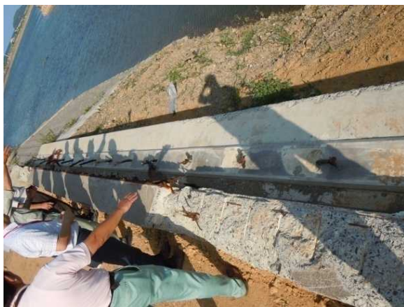
写真27 アンカーバーの変形あと
