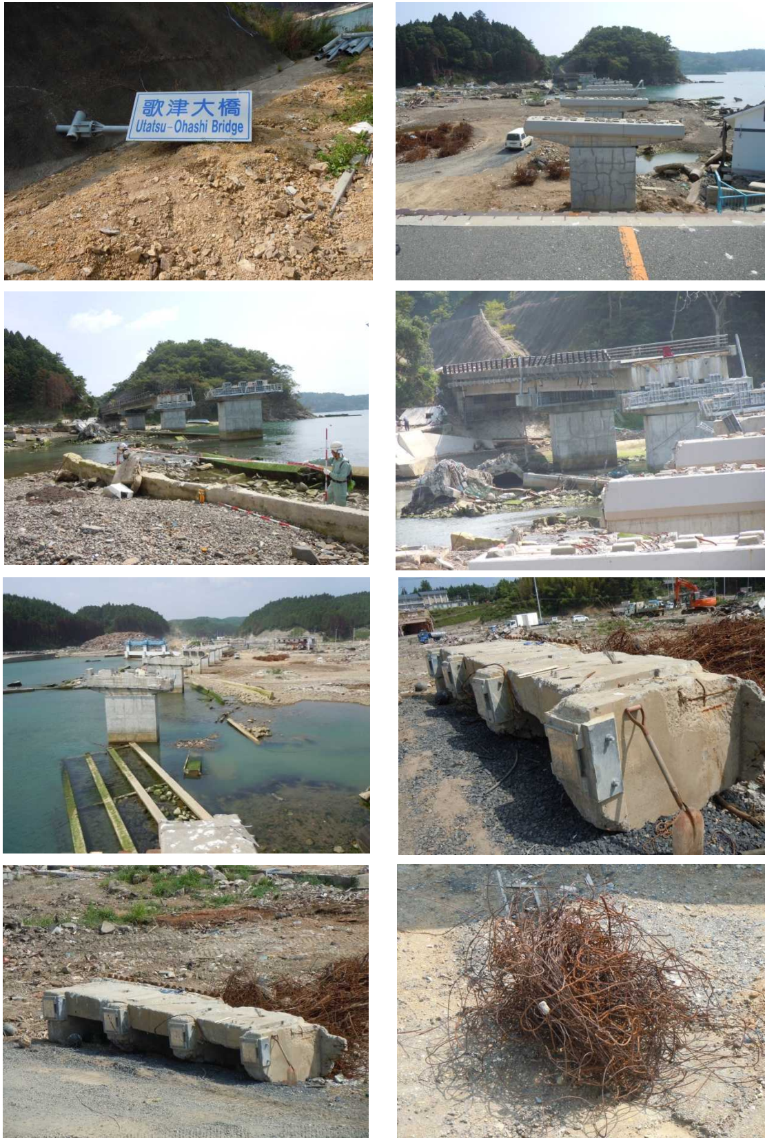
写真37 歌津大橋流失状況
