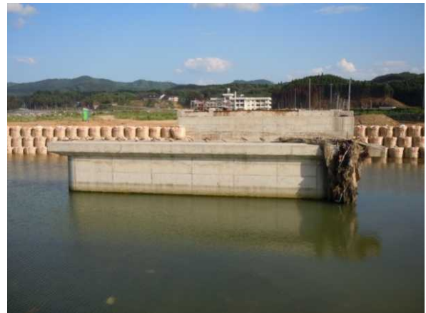
写真26 橋桁流失状況
