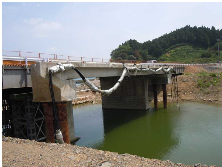
写真4 2 流失を免れた側道橋
