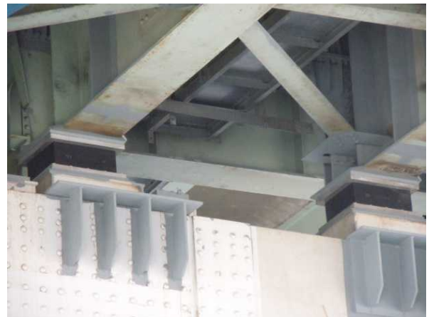
写真13 P56 ジャッキアップ用ブラケット
