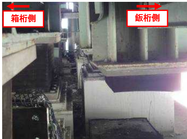
写真8 P56のゴム支承破断状況
