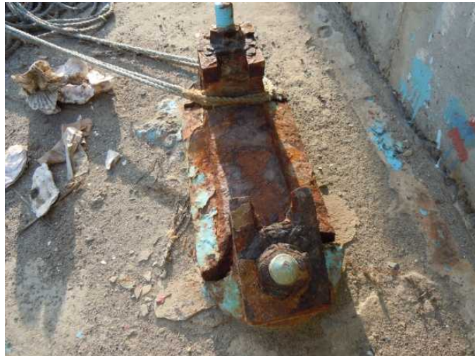
写真32 支承損傷状況
