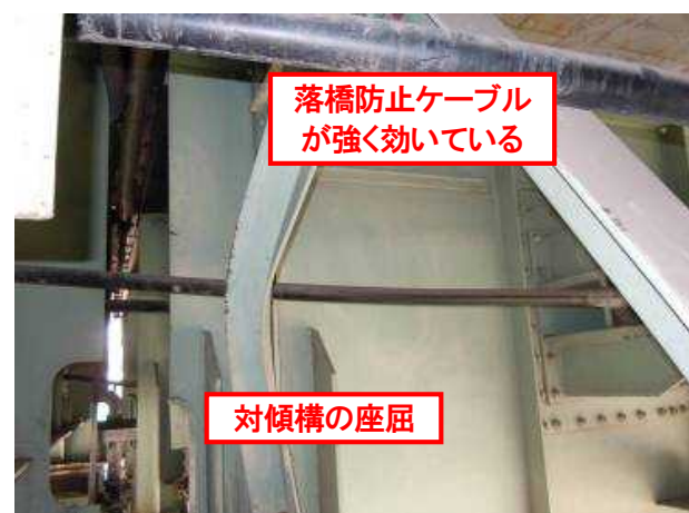
写真11 P56上の落橋防止ケーブル
