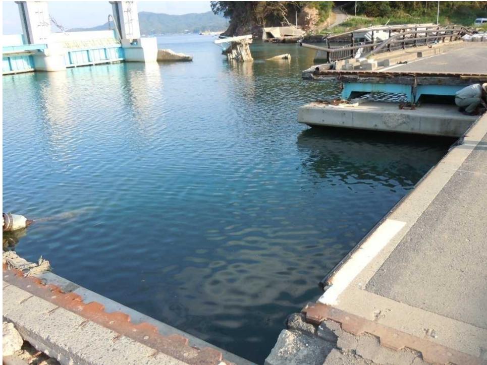
写真30 橋桁流失箇所の状況
