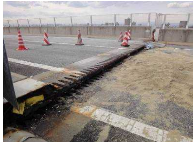
写真9 P56上の鋼製フィンガージョイント
