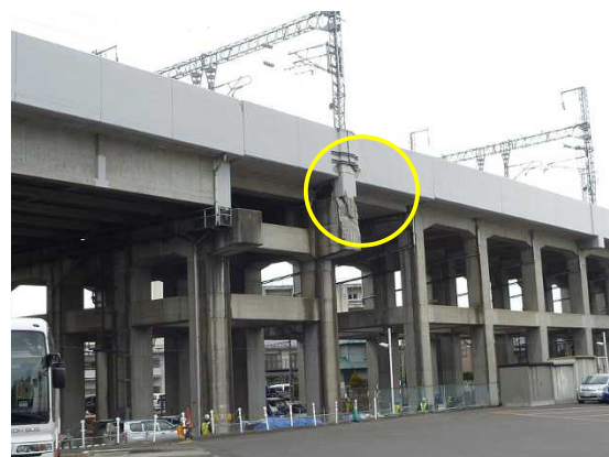
写真4 車通りBVの損傷状況
