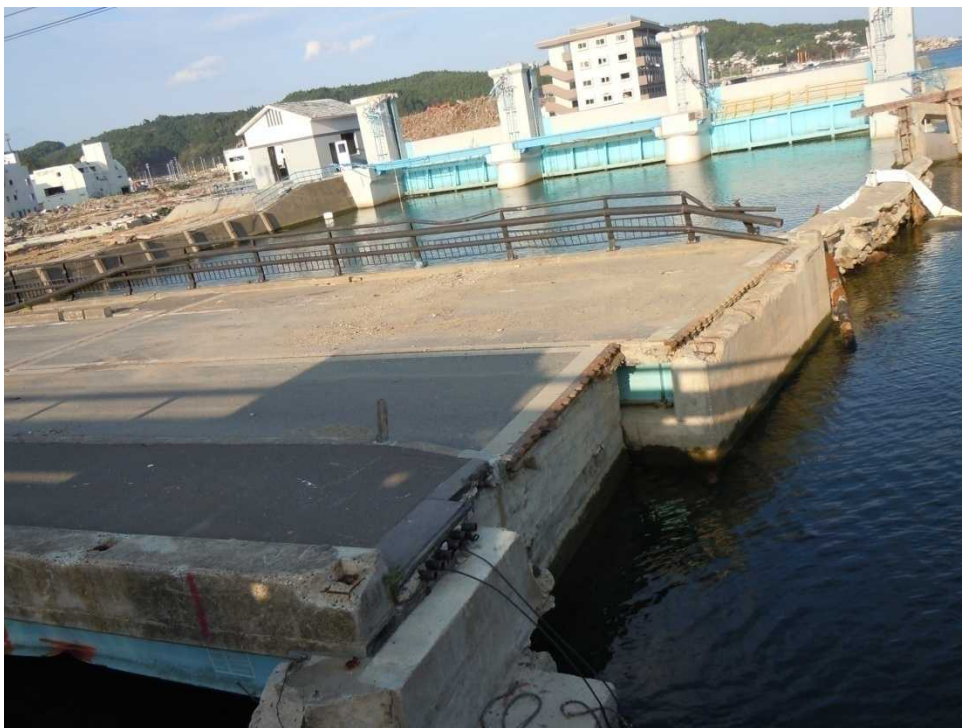
写真31 背面土工部の流失状況
