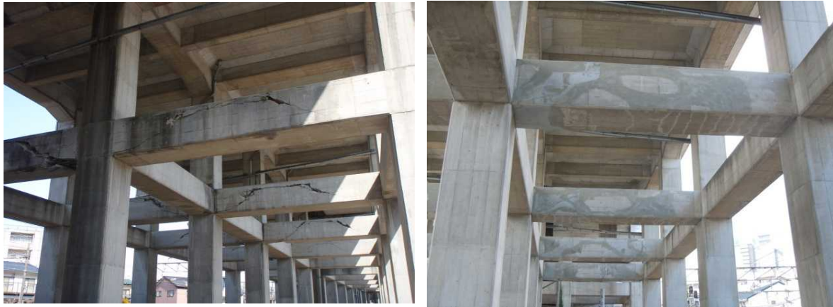
写真6 第2小田原B Lの損傷状況と補修完了状況
