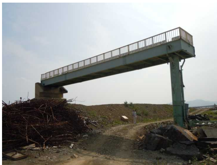
写真57 流出を免れた鋼桁
